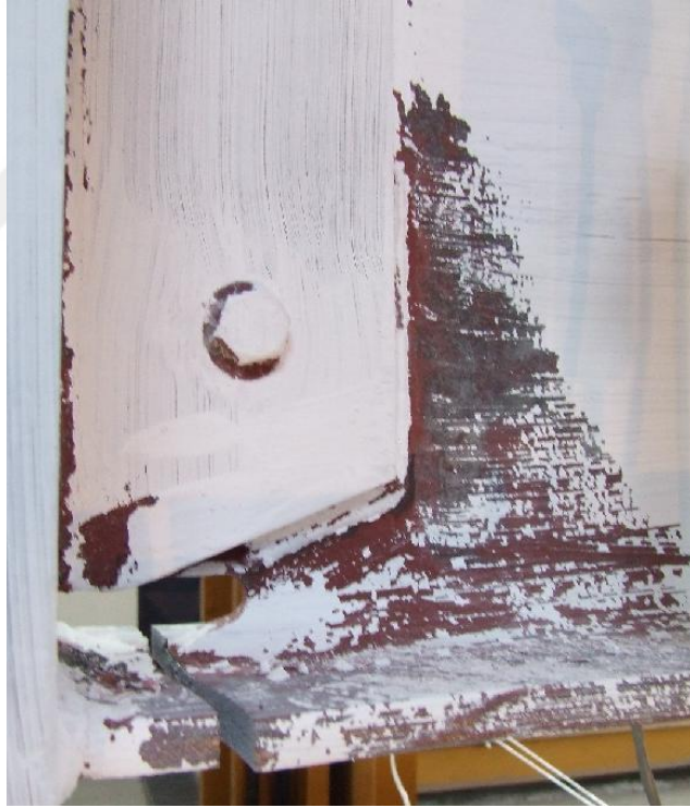
Şekil 4.17 : Test 1 numunesi deney sonu birleşim altbaşlık bölgesi yakın görünüşü.
