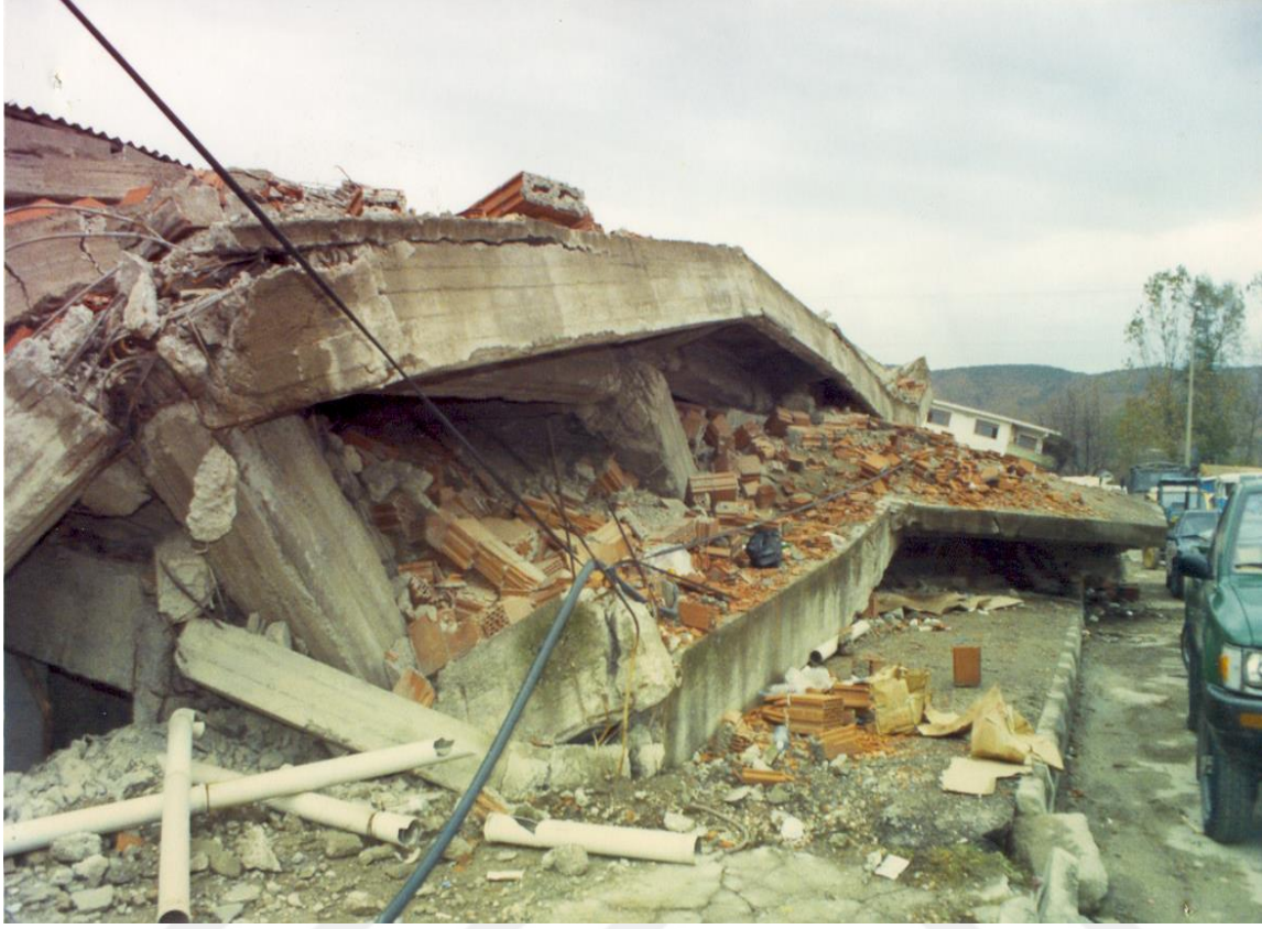
Resim 3.21. Kaynaşlı Karaçalı Mahallesi D-100 karayolu üzeri, 5 katlı iken tamamı yıkılan ve doğu yönüne çevrilerek yıkılan bina (1999), (Kaynaşlı 2000 Yıllığı dergisi, s.104) [48].
