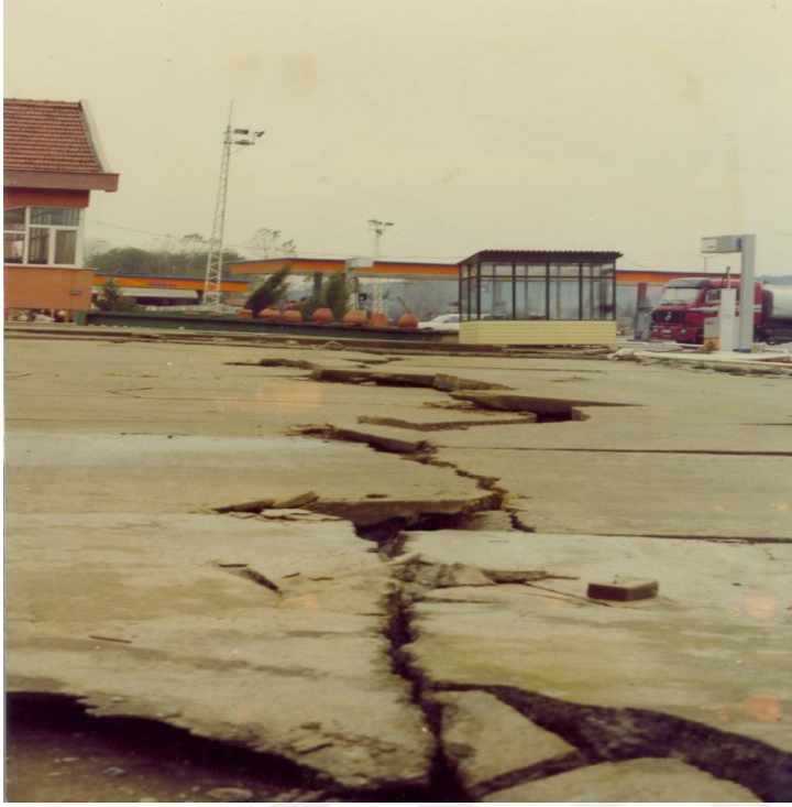
Resim 3.4. Kaynaşlı Karaçalı Mahallesi mevki, Korupark dinlenme tesisleri fay yüzey kırığı (1999), (Kaynaşlı Kriz Merkezi Arşivi).
