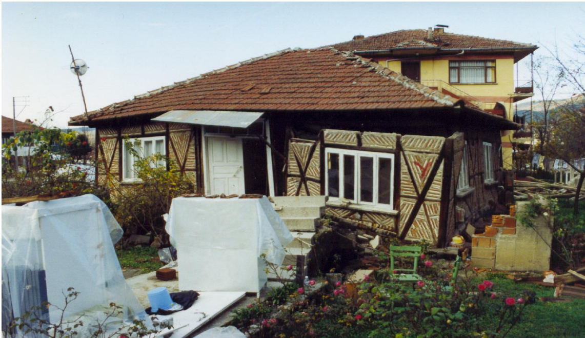
Resim 3.14. 12 Kasım 1999 Depremi. Geleneksel tip karma yapıda deprem hasarı (1999), (Kaynaşlı Kriz Yönetim Merkezi Arşivi).
