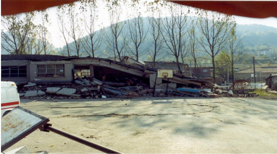
Resim 3.38. 12 Kasım 1999 Depremi. Yıkılan Kaynaşlı Lisesi binası (1999), (Kaynaşlı Kriz Yönetim Merkezi Arşivi).
