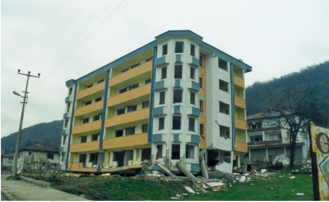
Resim 3.15. 12 Kasım 1999 Depremi. Betonarme yapı deprem hasarı, Kaynaşlı Kumluca Mahallesi Mevkii (1999), (Kaynaşlı Kriz Yönetim Merkezi Arşivi).
