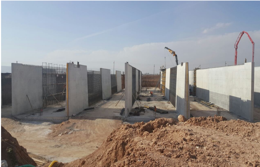
Şekil 4.2. Şanlıurfa merkez aat inşaatı (havalandırma havuzu).
