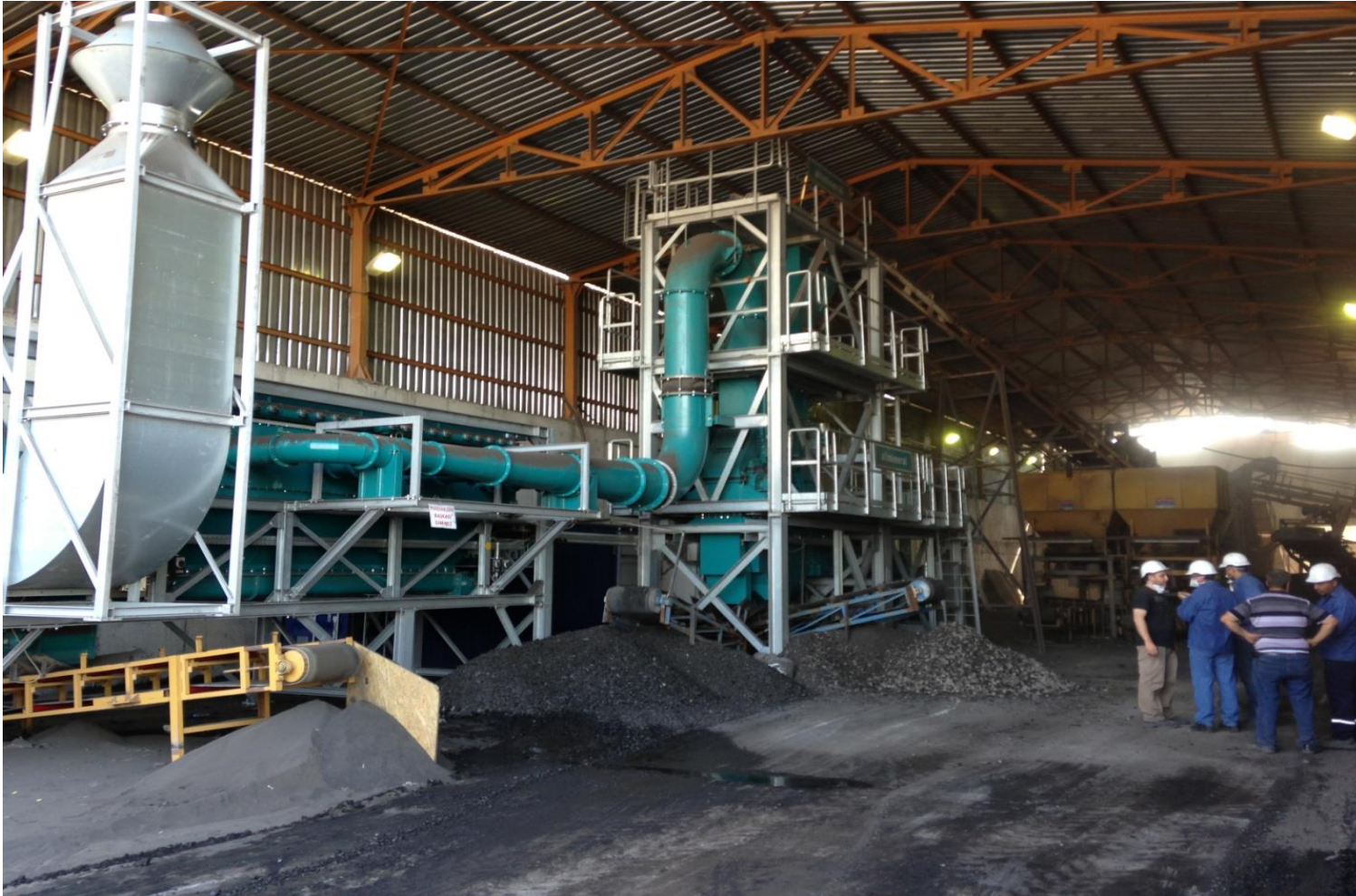
Şekil 4.27. Dereköy torbalama tesisleri-yedek ünitesinde kurulan kuru zenginleştirme ünitesi genel görünümü.
