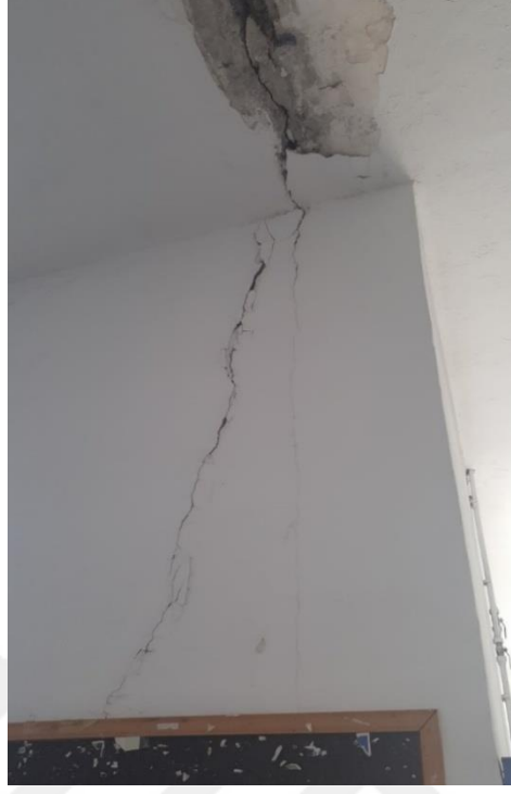
Şekil 6. 56 Tarihi kışlaya ait mevcut bir köşe hasarı
