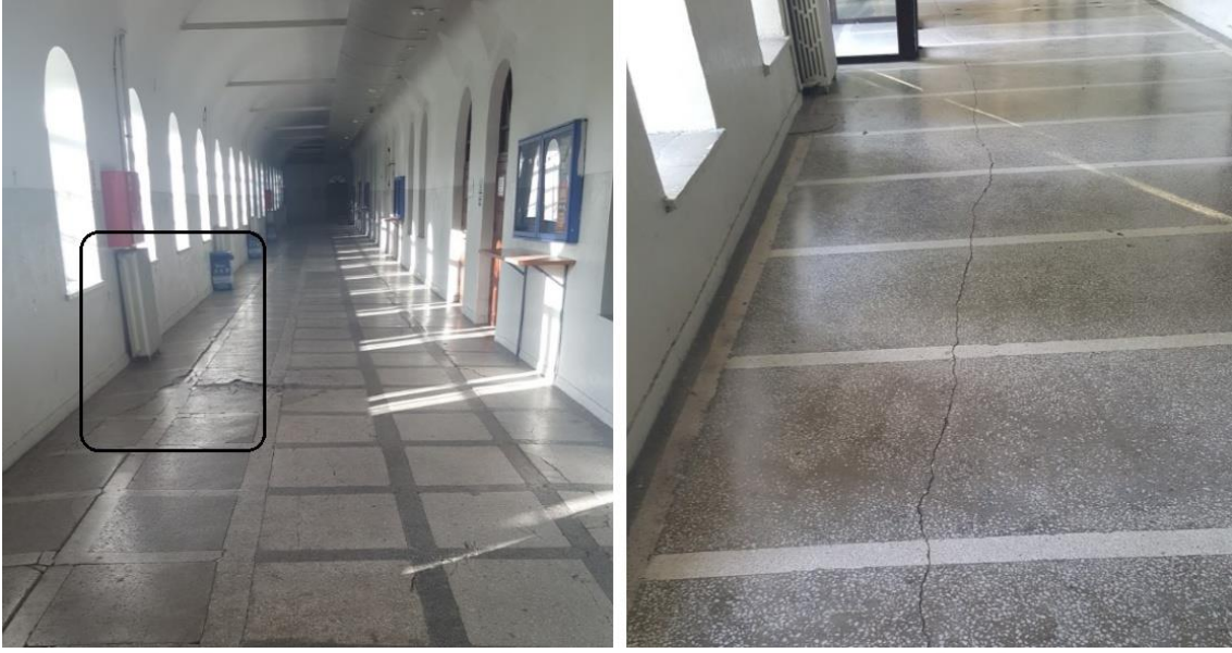
Şekil 6. 61 Tarihi kışlanın zemin çatlakları
