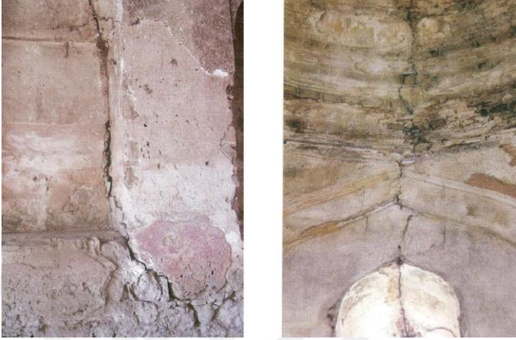
Şekil 2. 22 Örnek oturma çatlakları [40], [52]
