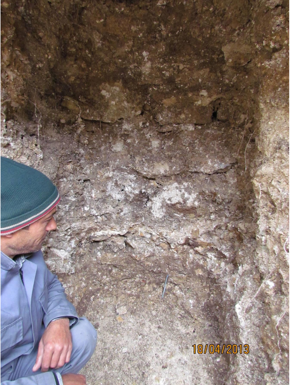
Şekil 6. 22 Araştırma çukuru 2.Kademedebina temeli ve temel altındaki yapay dolgu [128]
