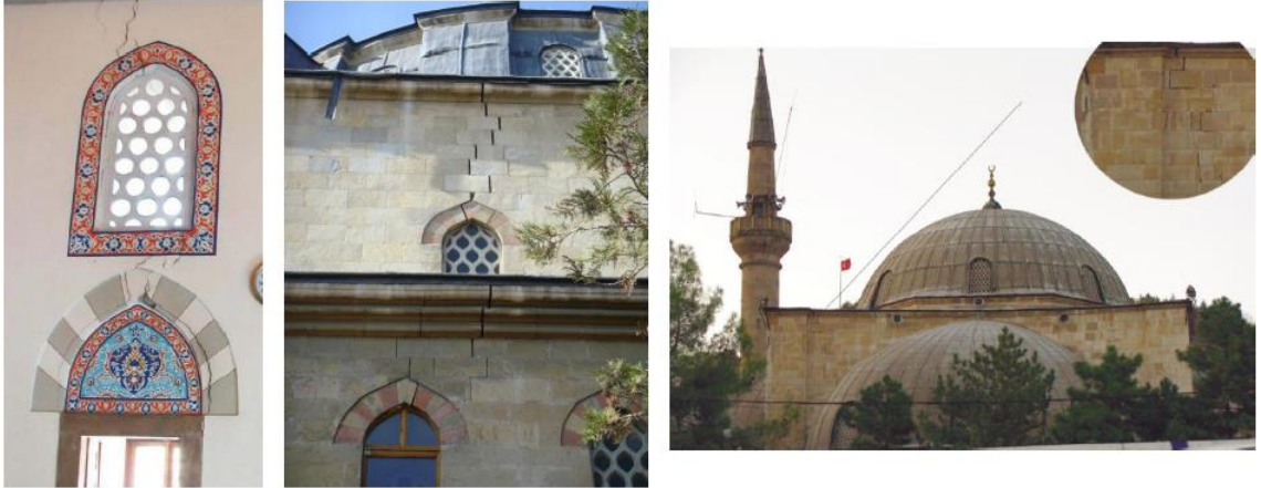
Şekil 2. 23 Örnek oturma çatlakları [40], [53]
