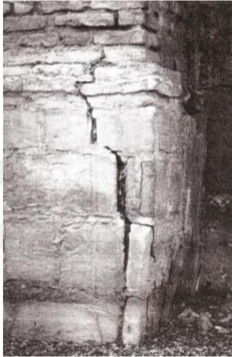
Şekil 2. 4 Taş ayakta oluşan örnek bir ezilme hasarı [40], [41]
