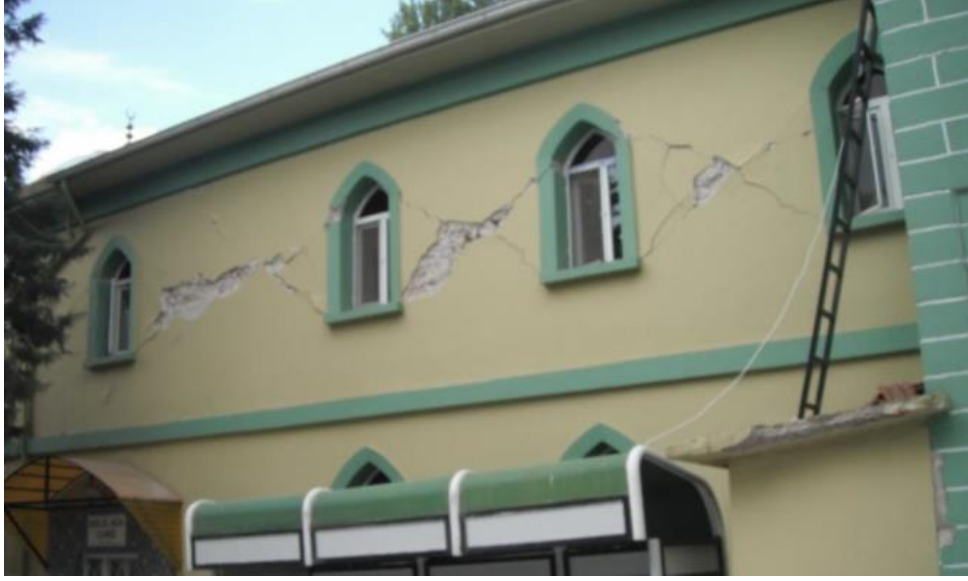
Şekil 2. 14 Depremde oluşan kesme çatlakları [40], [45]
