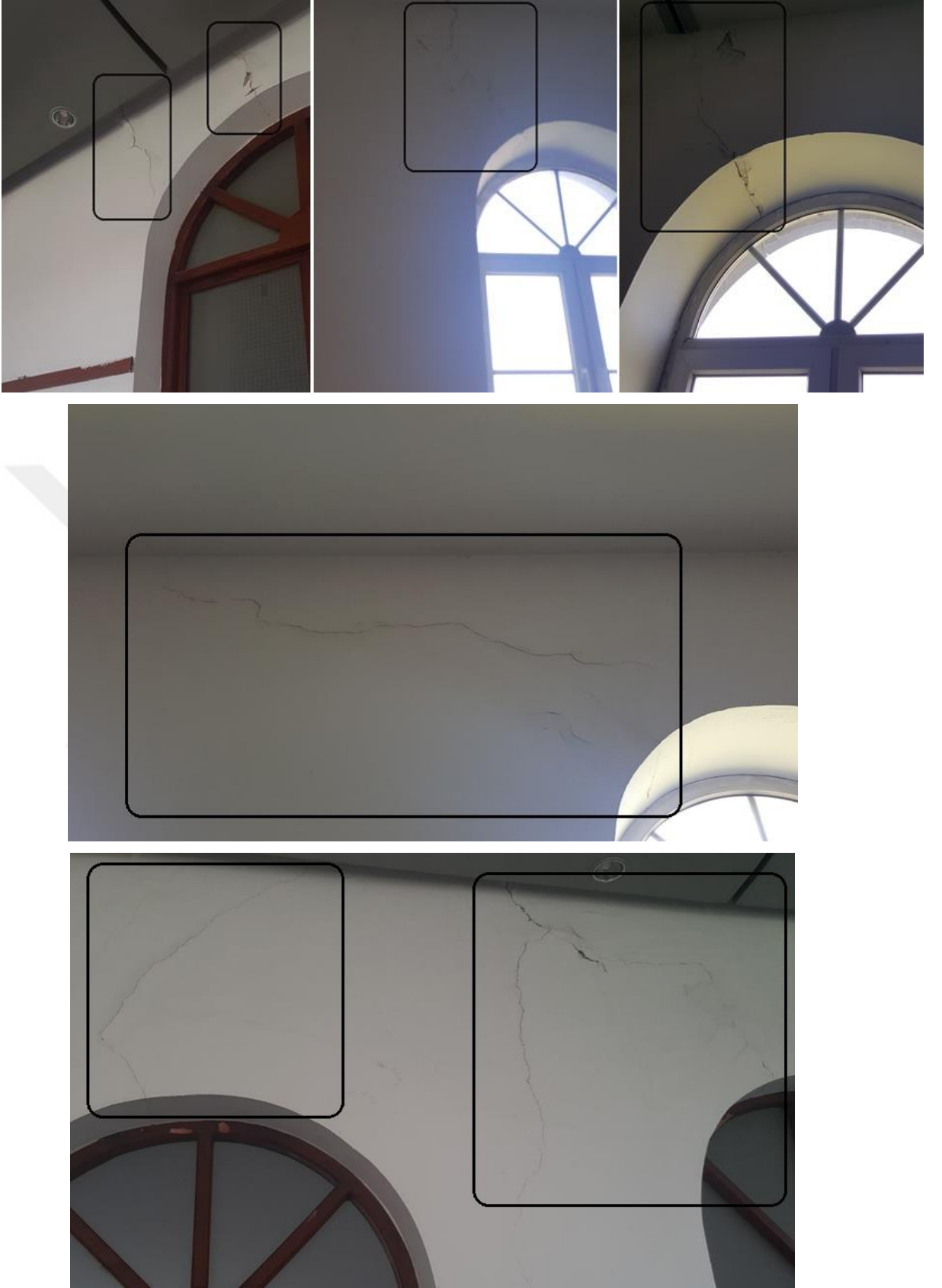
Şekil 6. 59 Tarihi kıslada mevcut spandrel hasarları
