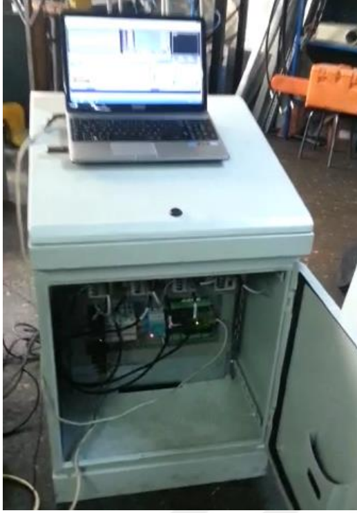
Resim 1.2. Kılavuz çekme makinası kontrol panosu
