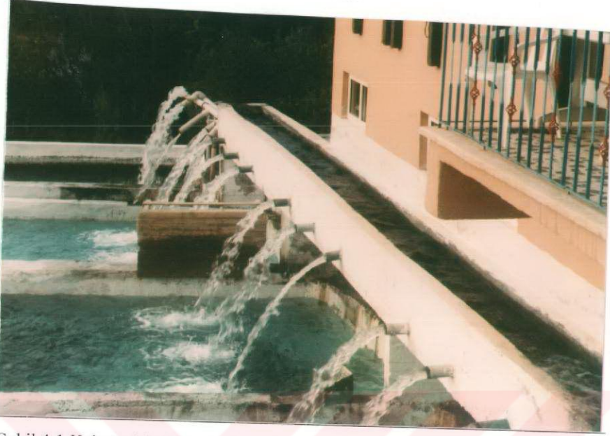
Şekil 4.1 Keban alabalık tesisi havuzlarının su giriş sistemi.
