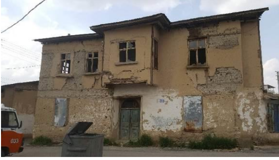
Şekil 2.40. Terk edilmiş ve kullanılamaz hale gelmiş yapı (2021)
