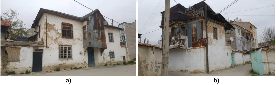
Şekil 2.43. a) Çıkmanın uyumsuz malzeme ile kaplama uygulaması ve yanlış onarım b) Çıkma, duvarın çatıda yanlış onarım sonucu uyumsuz malzemeler ile muhdes olarak kaplanmıştır (2021)
