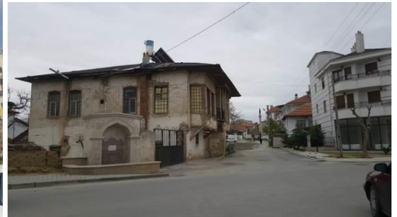
Şekil 2.39. Terk edilme ve bakımsızlık sonucu oluşan malzemede bozulmalar görülmektedir (2021)
