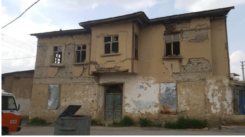
Şekil 2. 14. Duvarlarda sıvaların dökülmesiyle ortaya çıkan kerpiç tuğlalar ve ahşap hatıllar (2021)
