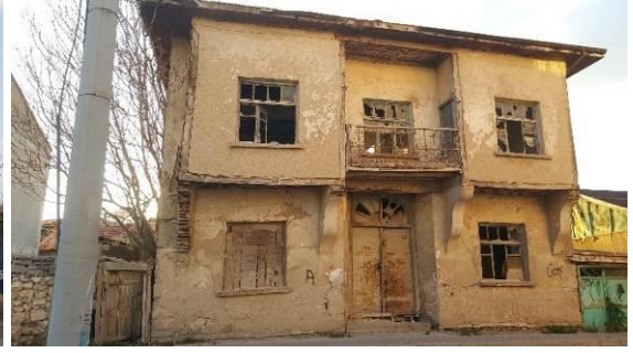
Şekil 2.41. Terk edilen yapı, hasar, bakımsızlık gibi etkenlerden kullanılamaz duruma gelmiştir (2021)
