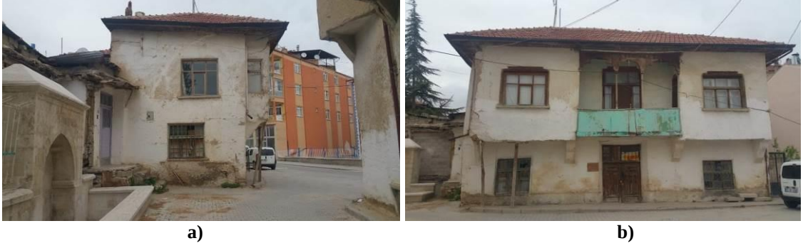
Şekil 2.47. Bakımsızlık sonucu a) yapının dış duvarlarında deformasyonlar görülür b) yapı elemanları ve duvarlarda deformasyon görülmektedir (2021)
