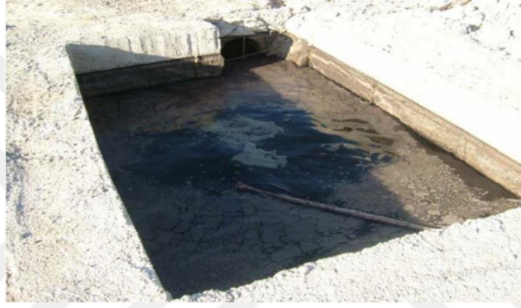
Şekil 2.20. Sızıntı Suyu Toplama Havuzu (Apaydın, 2007)
