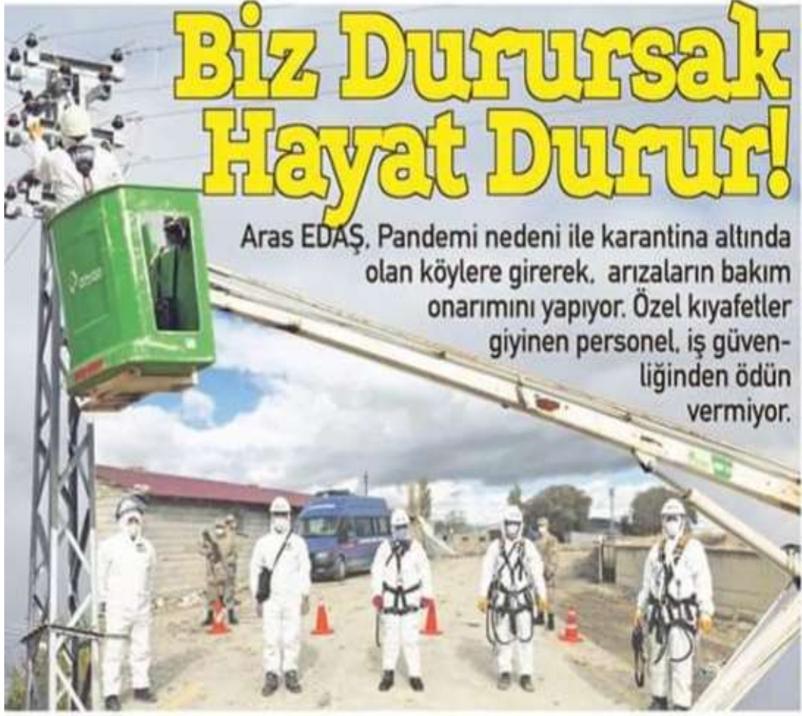
Şekil 50 Karantina Altındaki Yerlere Elektrik Verilmesi
