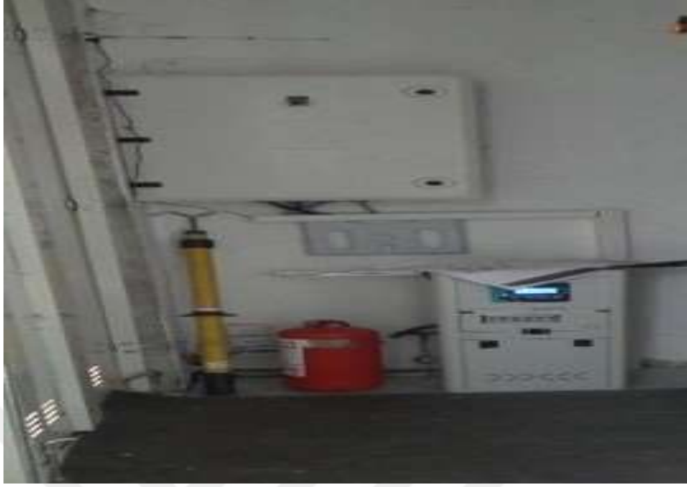
Şekil 63 Kabin İçi Aydınlatma Akü Grubu
