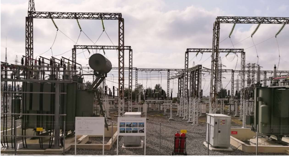
Şekil 55 Hava Yalıtımlı ve Açık Şalt Sahalı Trafo Merkezleri
