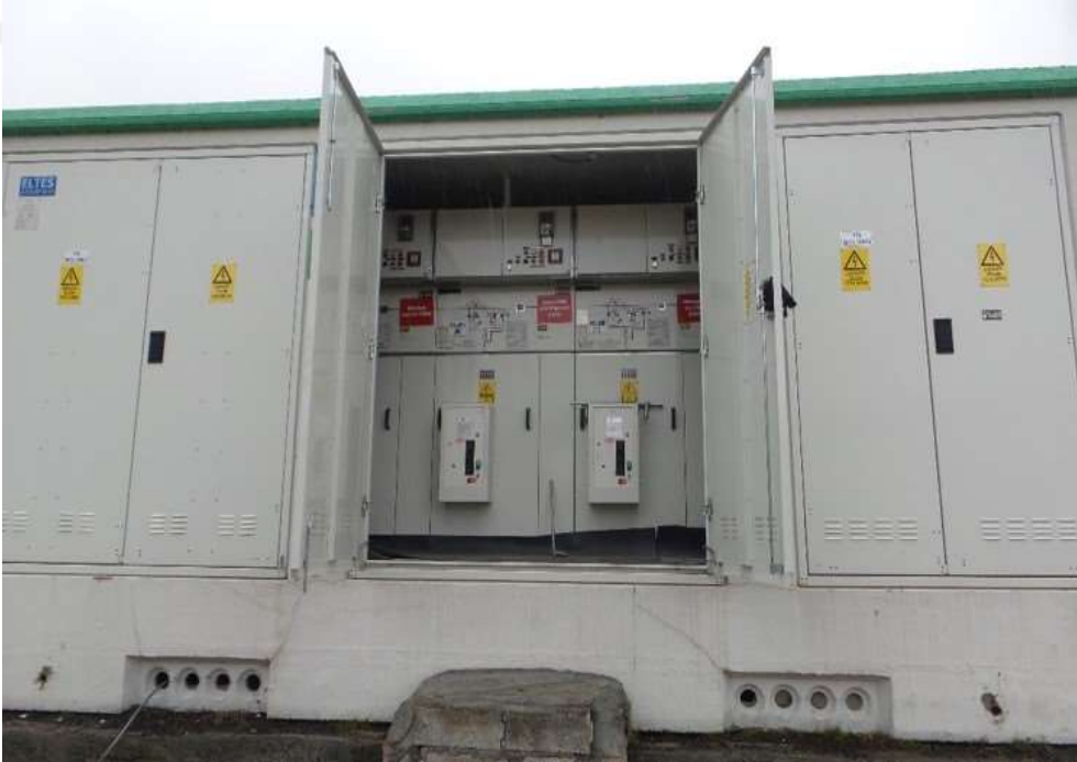
Şekil 62 Bina (Kabin) Tipi Transformatör
