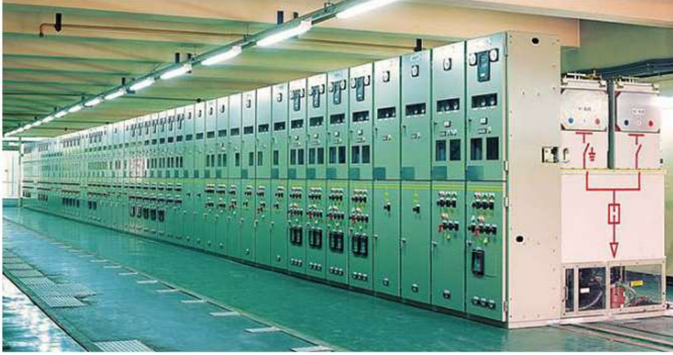
Şekil 56 SF6 Gazıyla Yalıtılmış Kapalı Ve Muhafazalı Trafo Merkezleri
