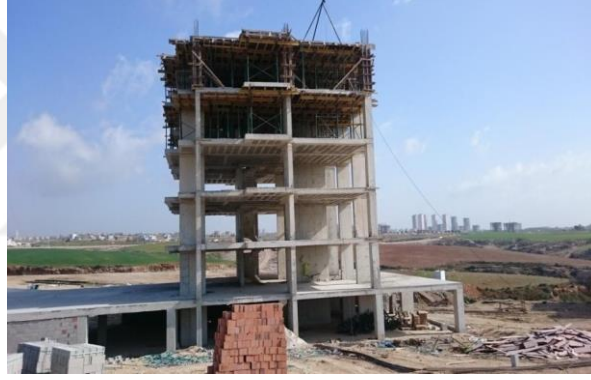
Şekil 4.1. A inşaatında güvenlik ağının olmaması
