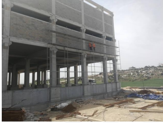
Şekil 4.7. B inşaatı uygun olmayan cephe iskelesi
