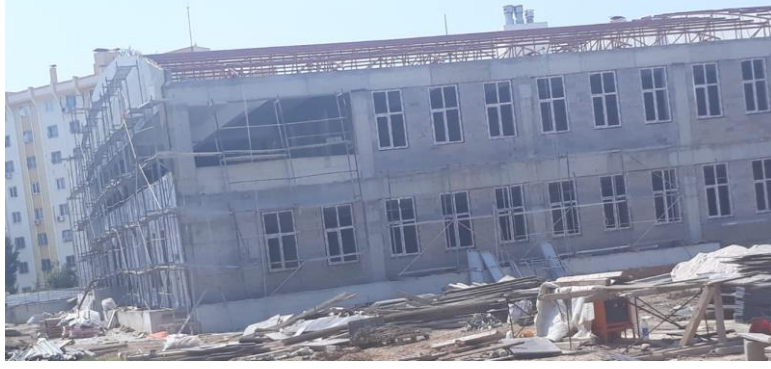
Şekil 4.16. C inşaatı dış cephe iskelenin uygun olmaması
