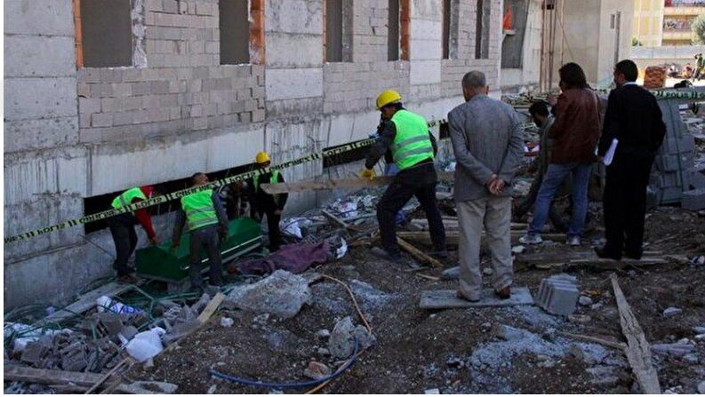
Şekil 4.21. C inşaatı yüksekte düşme sonucu iş kazasının yaşanması
