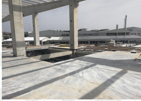
Şekil 4.12. B inşaatı asansör boşluğunda kenar koruma sistemin olmaması
