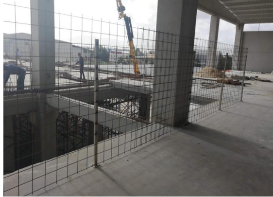
Şekil 4.13. B inşaatı asansör boşluk etrafı kapatılarak düşmeye karşı önlem alınması
