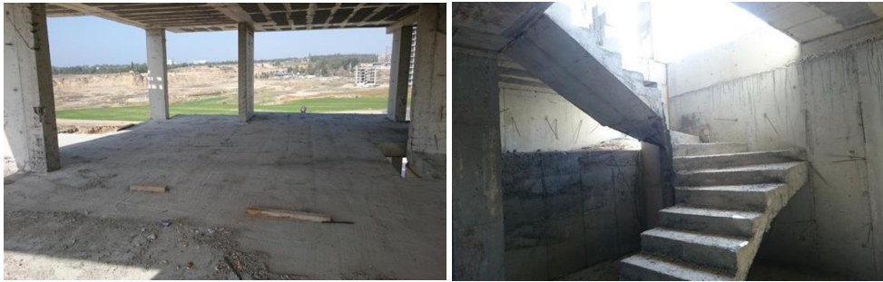
Şekil 4.5. A inşaatı kat kenar koruma ve merdiven korkulukların olmaması
