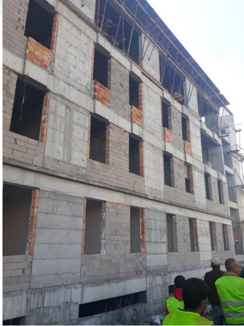
Şekil 4.20. C inşaatı için güvenlik ağının kullanılmaması
