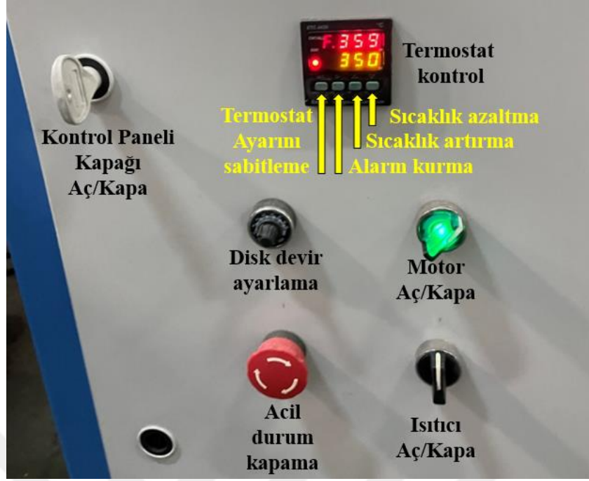
Şekil 3.31 Kontrol Paneli – Termostattan Sıcaklık Ayarlanması.
