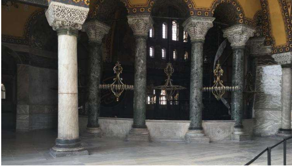
Şekil 2.32 Fossati onarımlarında eksen kayıklığının düzeltildiği belirtilen sütun örnekleri. Kuzeydoğu eksedradan görünüm (2020)
