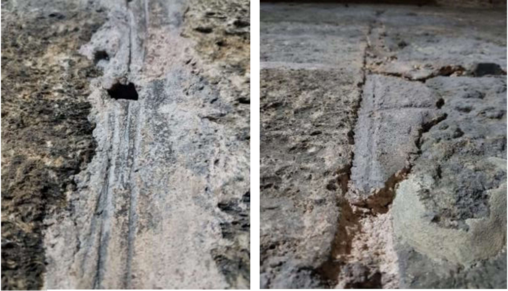
Şekil 3.17 Kuzey nef payanda içindeki düşey derzde harç üzerine çekilmiş çizgiler (2017)
