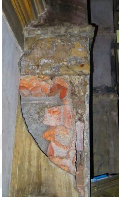
Şekil 3.33 Kırılmış duvar kaplaması arkası tuğla ve harç dolgusu ana mekân kuzey iç cephe (2017)
