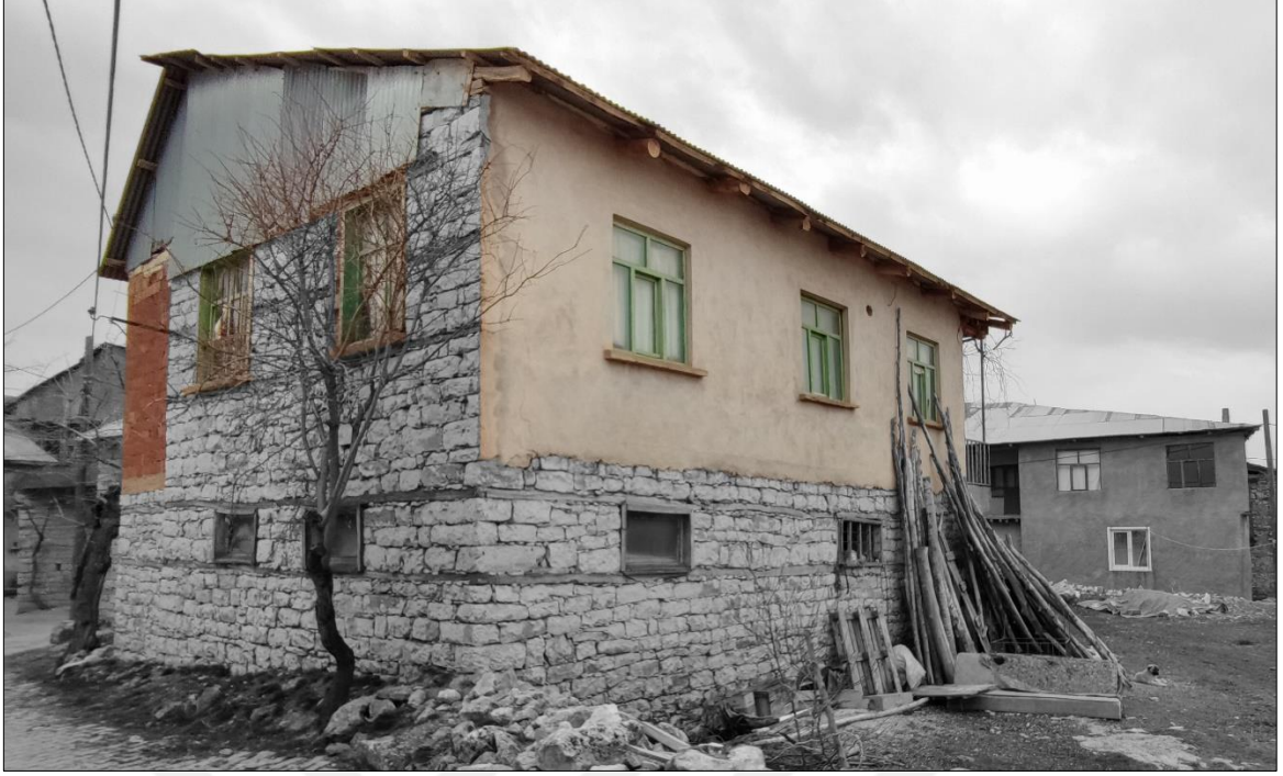
Şekil 4.46: Niteliksiz yapı ve mimari eleman ile niteliksiz yüzey malzemesi eklenmiş geleneksel Kuru konutu (Fotoğraf: Orjinal, 2021).
