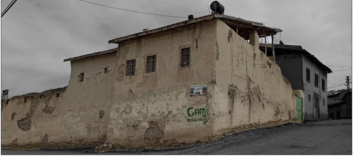
Şekil 4.16 : Dış cephe duvarlarında yer yer sıva kayıplarına uğrayan Aşağılupınar geleneksel konutu (Fotoğraf: Orjinal, 2021).
