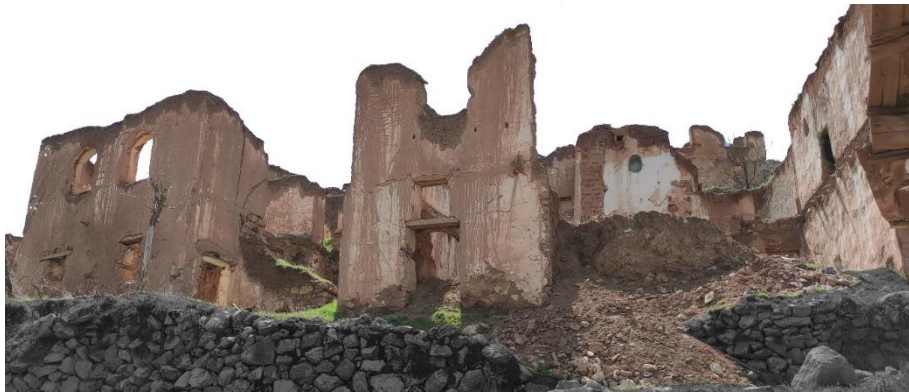
Şekil 4.120 : Yerleşimdeki yapılar yüksek oranda ağır strüktürel hasarlar içermektedir (Fotoğraf: Orjinal, 2021).
