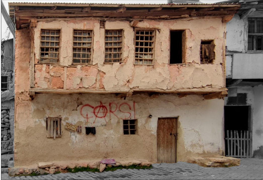
Şekil 4.63 : Terk edilen geleneksel yapıda çevresel etkiler sonucu oluşan bozulmalar ve malzeme kayıpları (Fotoğraf: Orjinal, 2021).
