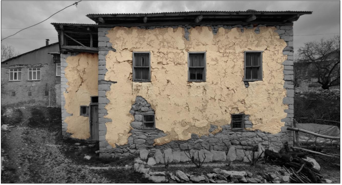
Şekil 4.71 : Dış çevre etkilerine karşı yapının ana malzemelerinden biri olan taş malzemenin korunması ve ısı kontrolüne yönelik uygulanan sıvalar gerekli bakımların yapılmaması sonucu bozulmalara ve malzeme kayıplarına uğramaktadır (Fotoğraf: Orjinal, 2021).
