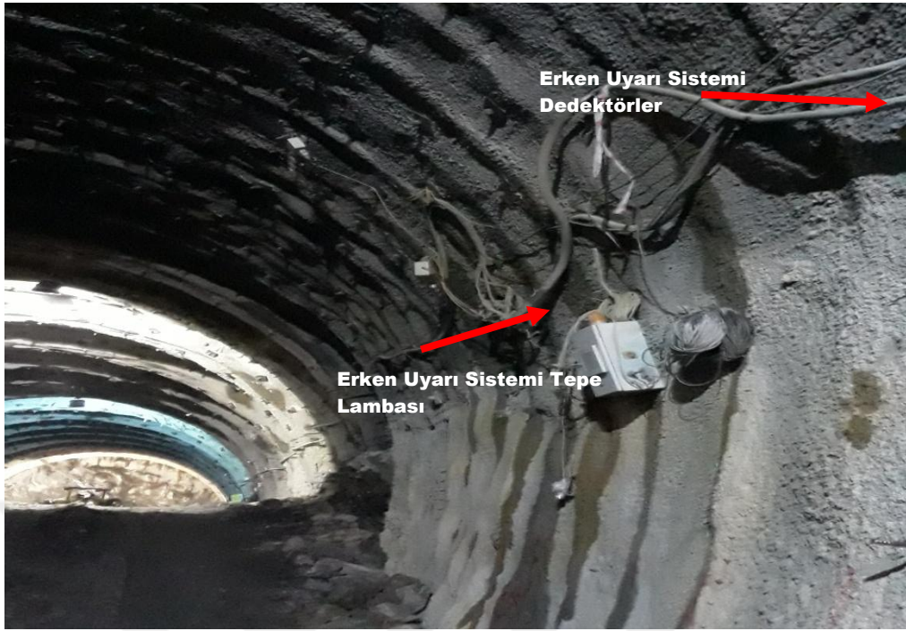
Şekil 5.2 Mithatpaşa-II Tüneli Sağ Tüp Gaz Emisyonlarına Yönelik Erken Uyarı Sistemi.
