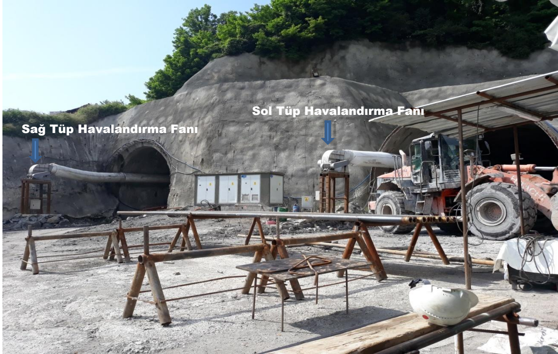
Şekil 5.5 Mithatpaşa-II Tüneli İkinci Makas Çıkış Sağ ve Sol Tüp Havalandırma Fanları.
