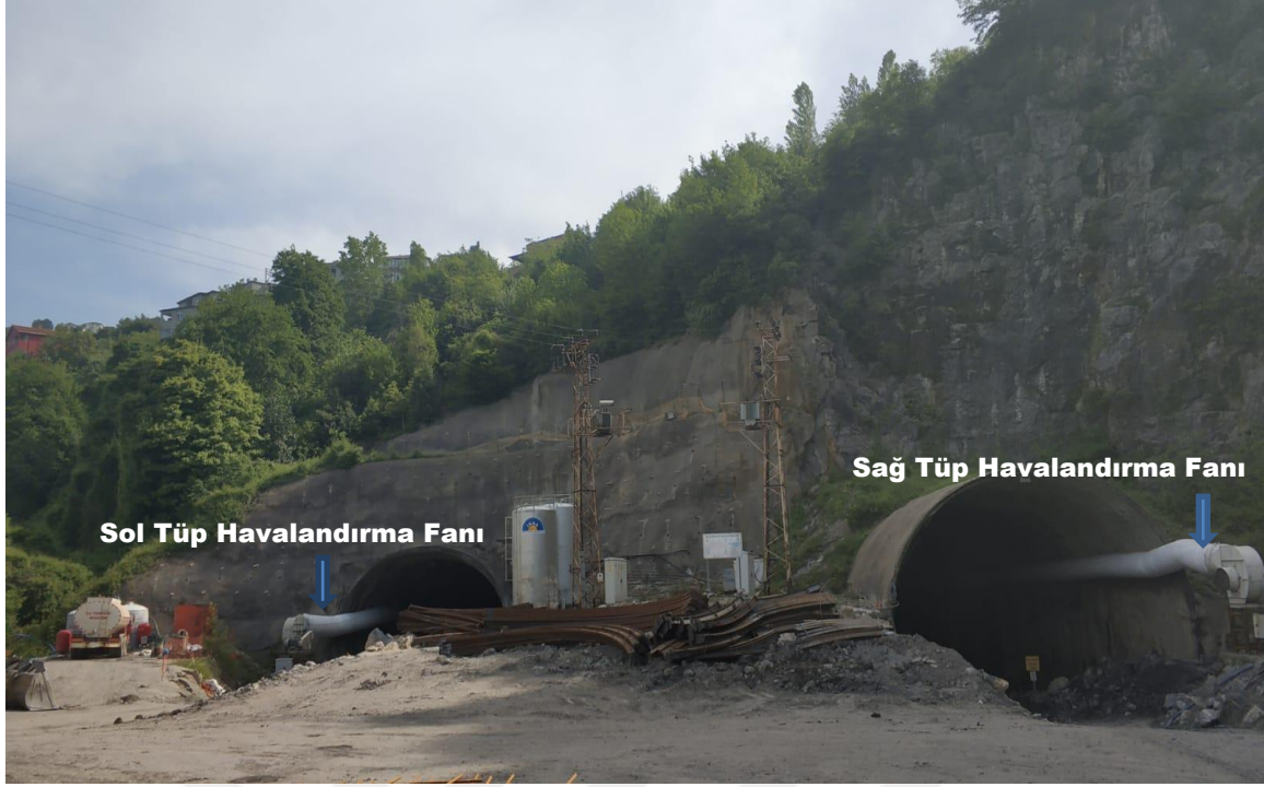
Şekil 5.4 Mithatpaşa-II Tüneli Bağlık Giriş Sağ ve Sol Tüp Havalandırma Fanları.
