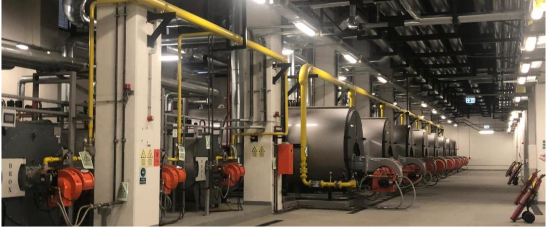
Şekil 6.8. Teknik hizmetler binasında yer alan ısıtma kazanları
