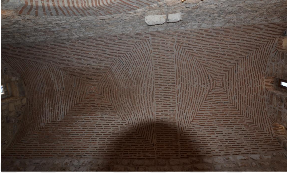
Resim 89. A Şapeli, tonoz örtü detayı, tuğla ve harçın görünümü (Alp, 2021)
