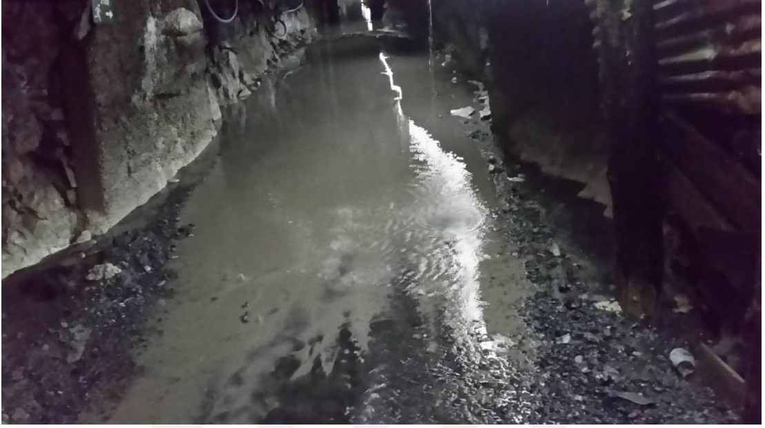
Şekil 5.1. Galerî içlerinde kırık ve çatlak zonları boyunca sızan yeraltı sularının görüntüsü
