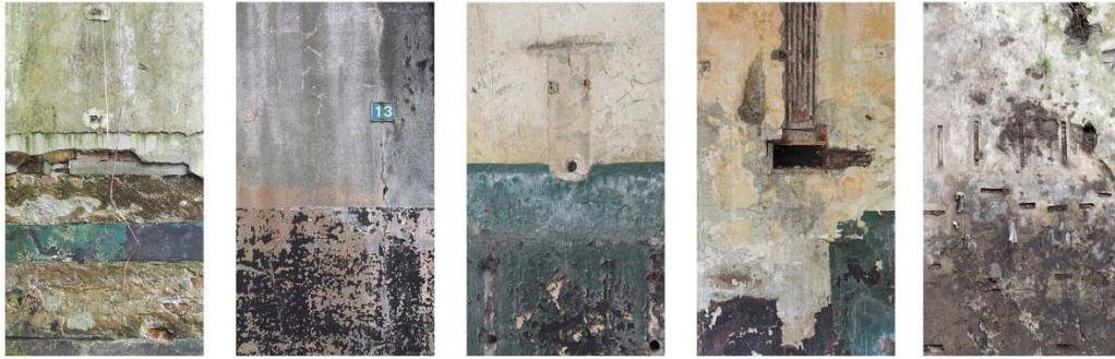
Şekil 5.26 Atölye binası duvarlarda çeşitli nedenlerle oluşturulan boşluklar, katmanlar (Müdahale Kararları ve Restorasyon Raporu).
