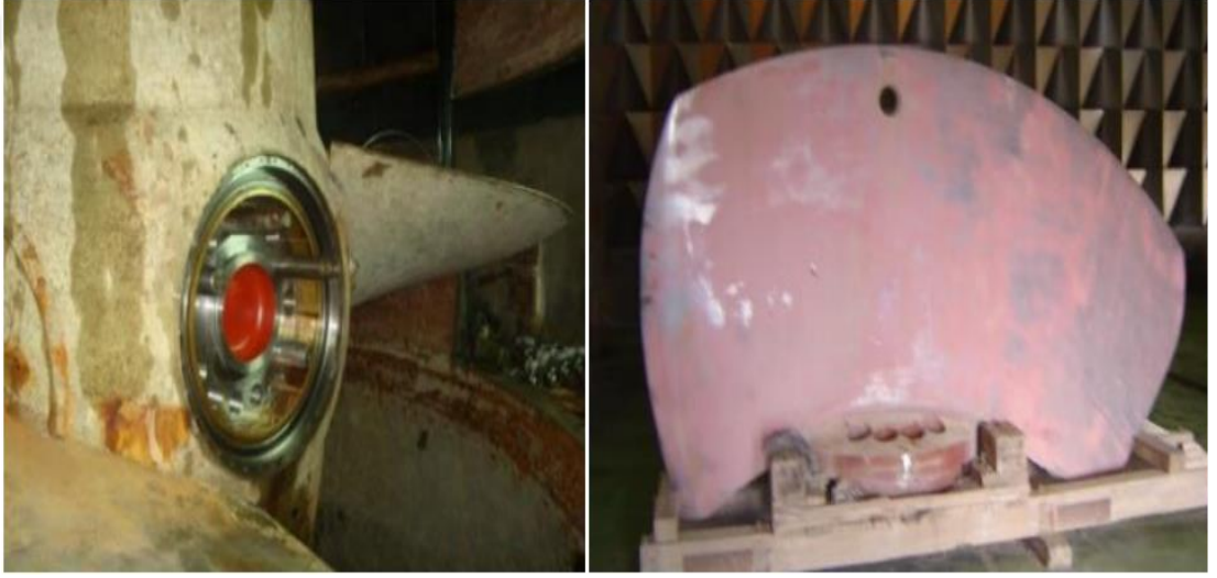
Şekil 2. 50. Türbin kavitasyon hasarı
