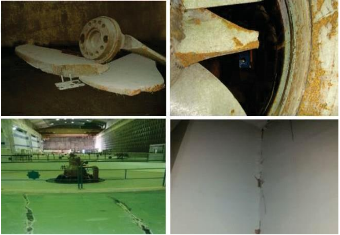
Şekil 1. 1. Haditha tesisindeki koşucu kanat hasarı (üst sıra) ve yapısal çatlaklar (alt sıra) [18].
