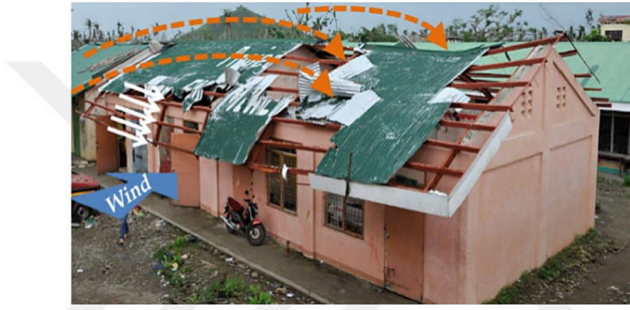
Şekil 2. Rüzgar etkisiyle meydana gelen çatı hasarı, Tanauan Okulu, Leyte, Filipinler. (Haiyan Tayfunu, 2013; Yang et al., 2018)
