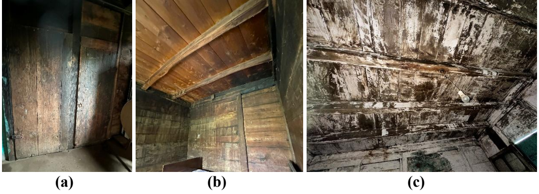
Şekil 4.14: Selime Hurşit Kulaber evi iç kapıları (a), özgün duvar ve yenilenmiş tavanı (b), tahrip olmuş tavanı (c) [Beyza Yangın arşivi, 2024].
