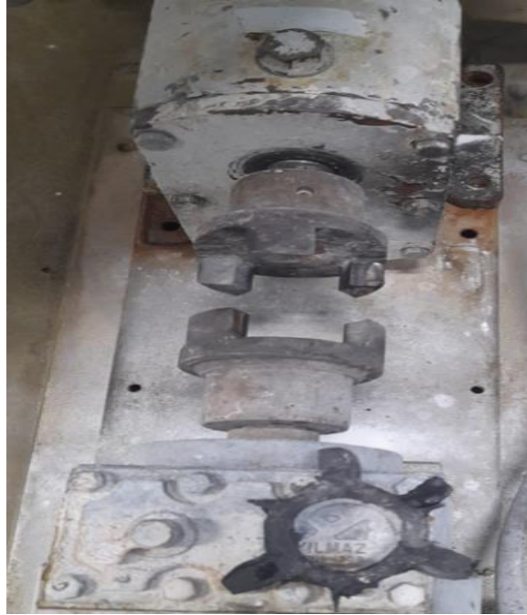
Şekil 2.4. Deforme Olan Pompa Bağlantı Parçası Kaplin
