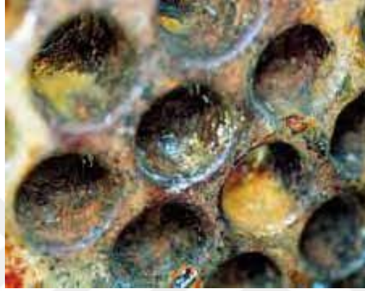
Şekil 1.11. Kalorifer kazanlarında kullanılan çelik borularda sülfat indirgeyen bakterilerden kaynaklanan mikrobiyolojik korozyon (Arslan ve Akçadoğan, 2014)
