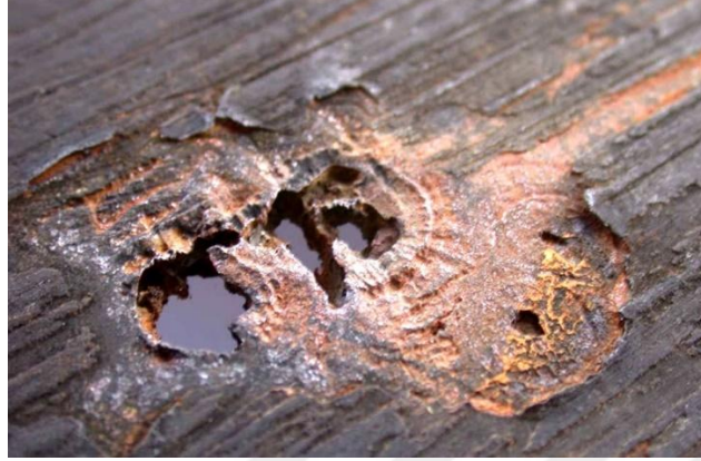
Şekil 1.5. Çukur korozyonuna uğrayan metal yüzey (URL-2, 2025)
