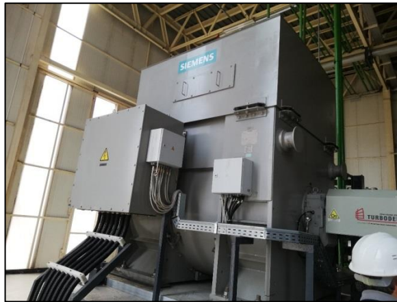
Şekil 3.21. ORC türbini tahrikli jeneratör
