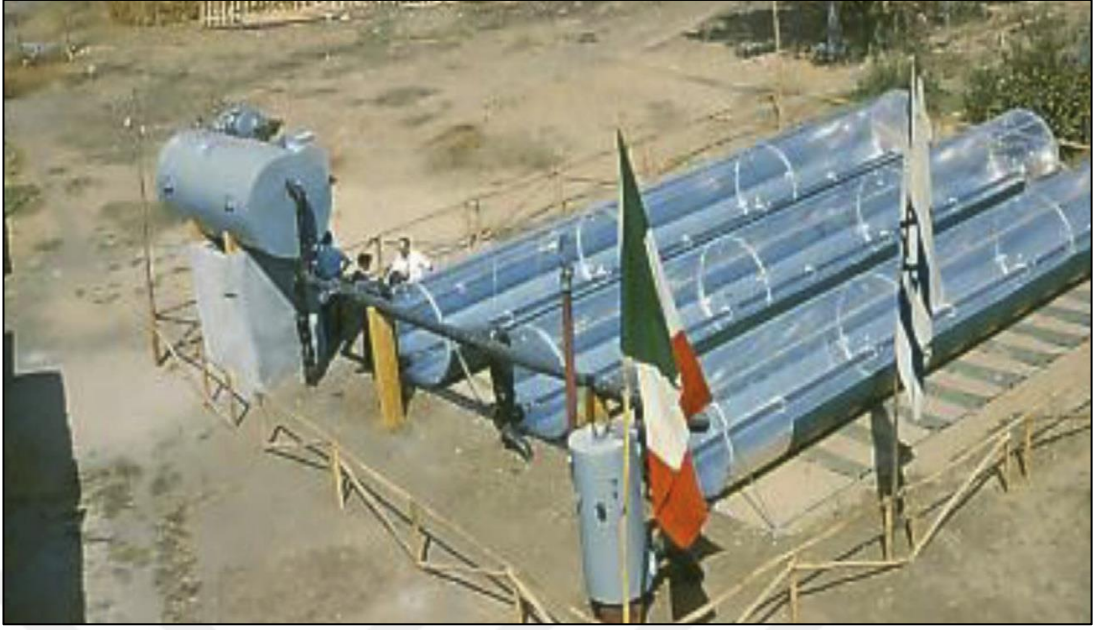
Şekil 1.9. 3 kW ORC Sistemi (1961) [22]
