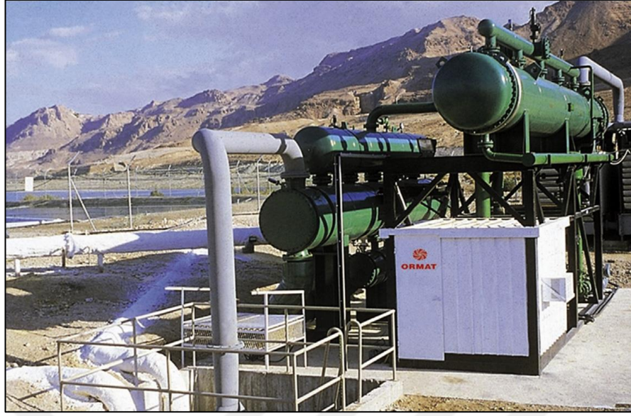
Şekil 1.15. İsrail'in Ölü Deniz'deki 150 kW güneş enerjisi havuzu ve güç ünitesi (Ormat)
