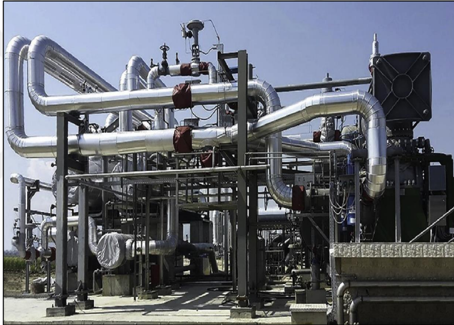
Şekil 1.29. 3,5 MW Jeotermal Enerji Santrali, Türkiye, 2015
