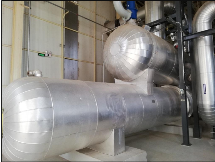
Şekil 3.18. ORC preheater ve evaporatör
