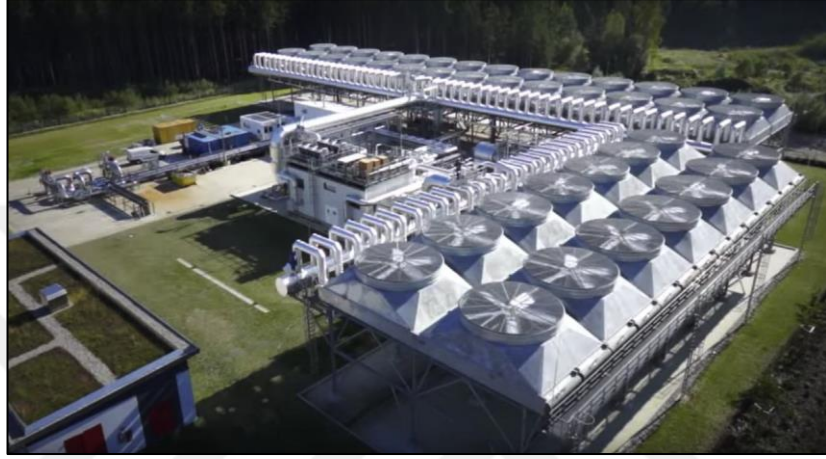
Şekil 1.27. 5,6 MW jeotermal enerji santrali, Durnhaar - Almanya, 2013
