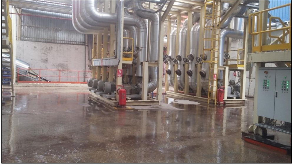
Şekil 3.11. Kızgın yağ hattı sirkülasyon pompa ve vana grubu
