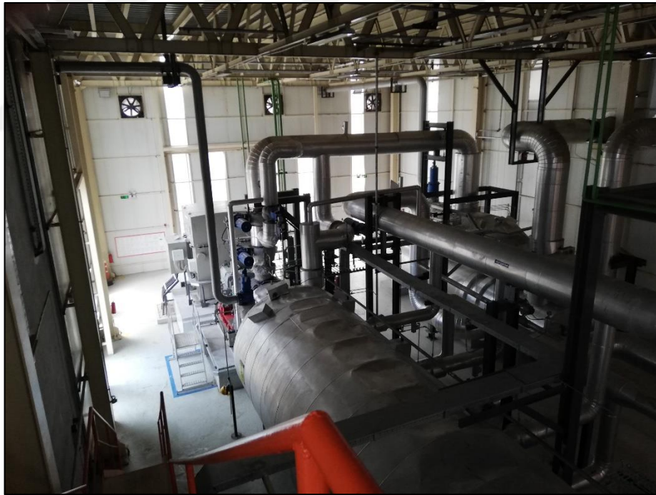
Şekil 3.17. ORC türbin odası üstten görünüm
