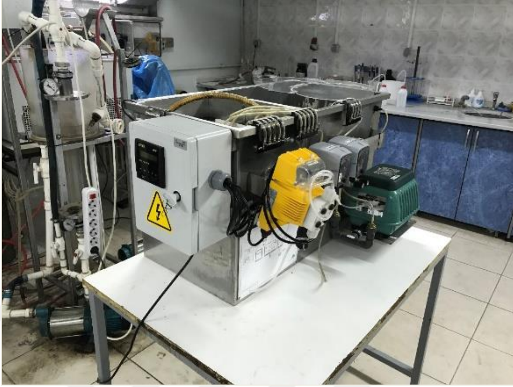
Şekil 3.1: MBR sistemi yan görünüşü.
