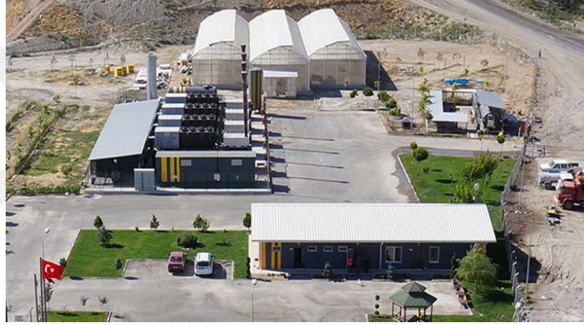
Şekil 4.2: Konya Çöp Gazından Elektrik Üretim Tesisi
