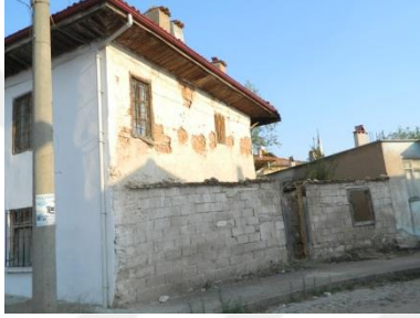
Şekil 5.3.3. Mehmet Bacakoğlu Evi kuzeybatı cephe duvar malzeme ve özgün sıvanın görünümü
