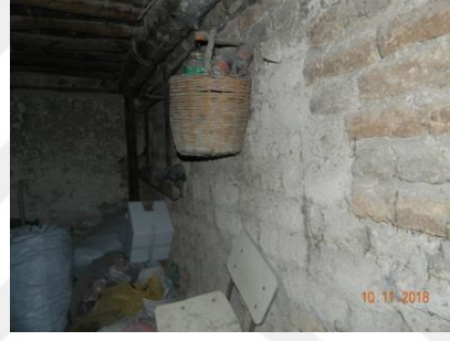
Şekil 5.9.4. Meryem Topal Evi sıvası dökülmüş kerpiç duvar görünümü
