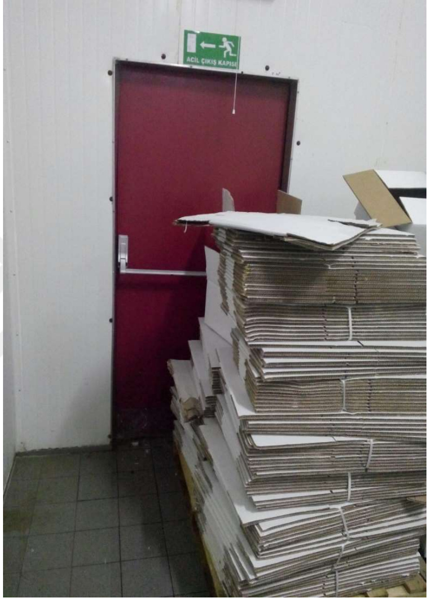
Şekil 4.8: T1 tesisinin malzeme istifi yapılmış acil çıkış kapısının önü
