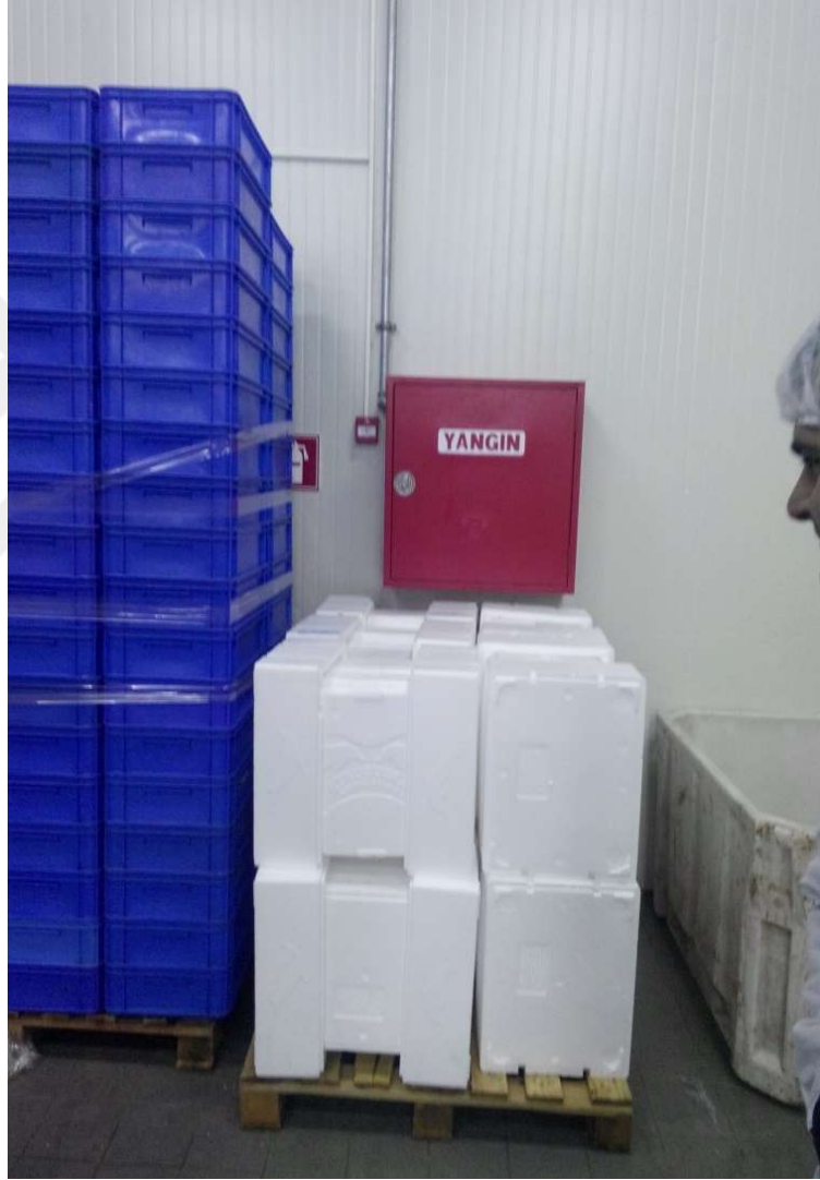
Şekil 4.7: Yangın söndürme cihazlarının çevresine malzeme istifi yapılan T1 tesisi
