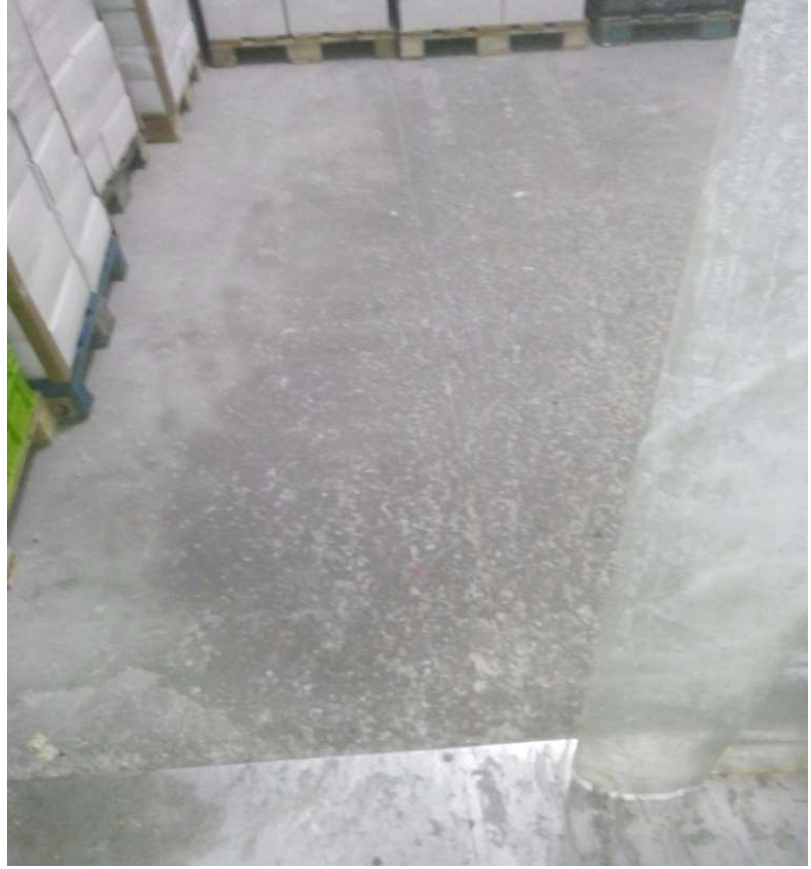
Şekil 4.3: T3 tesisinde buz tutan soğuk muhafaza deposunun içi
