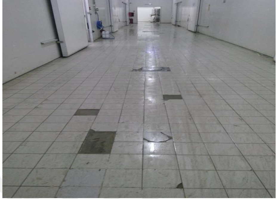
Şekil 4.4: T1 tesisinde sevkiyat alanlarında meydana gelen zemin bozuklukları
