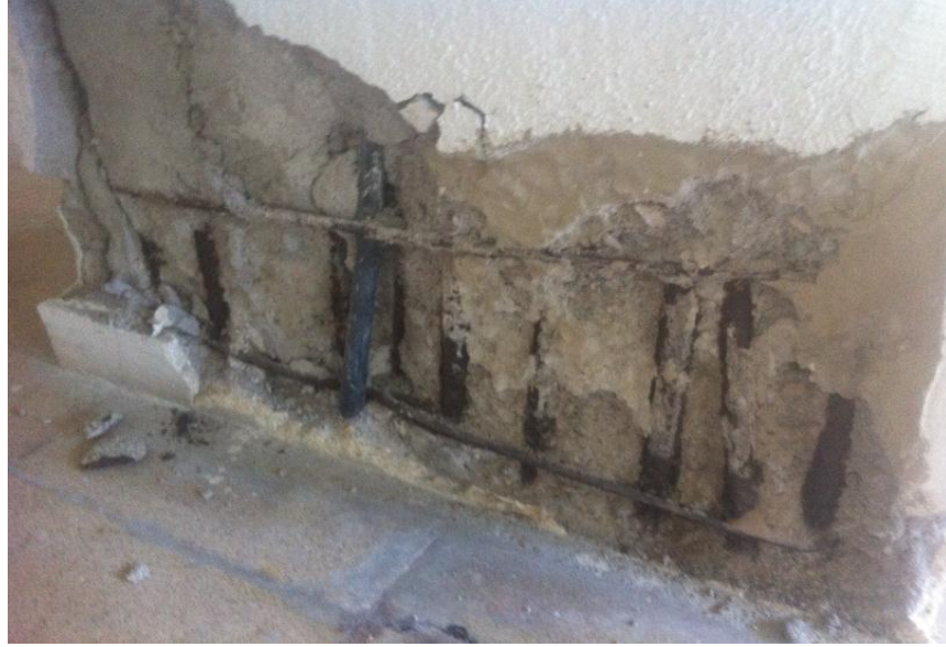
Şekil 4.12: Korozyondan dolayı hasar görmüş kolon.
