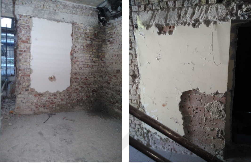
Şekil 4.10: Yığma duvarlarda açılıp sonradan kapatılan bazı boşluklar
