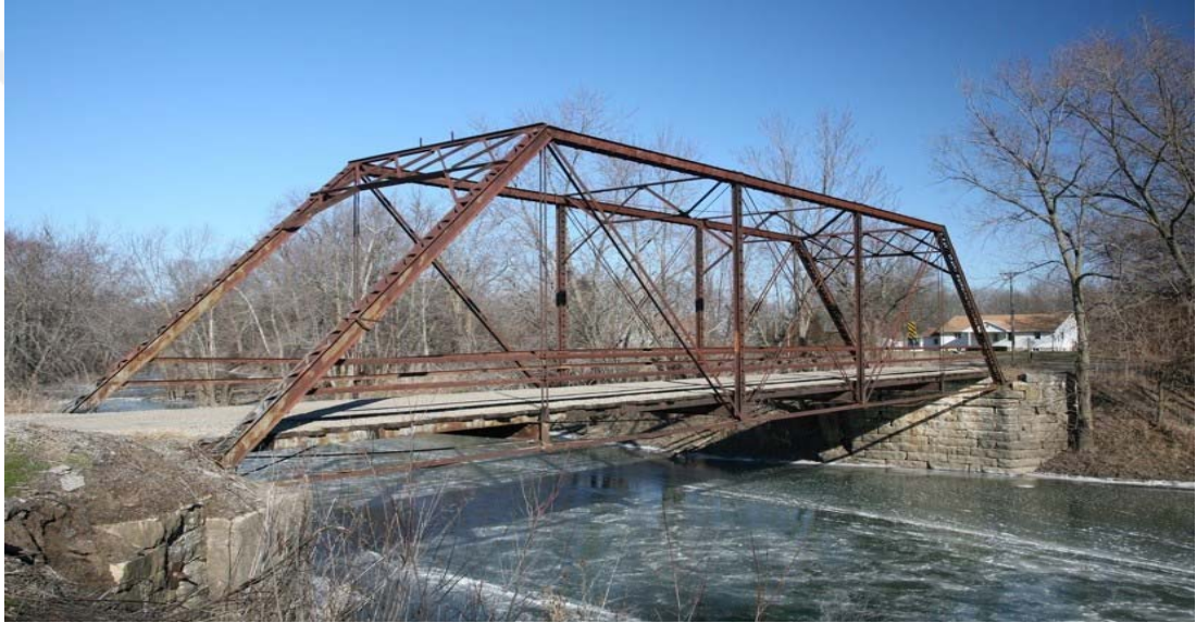
Şekil 2.6. Kafes kirişli köprü
