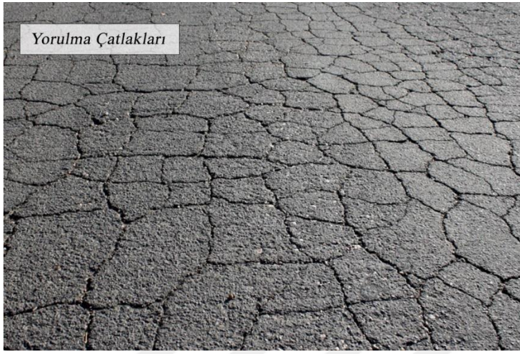
Resim 2.5. Timsah sırtı çatlaklar [43]
