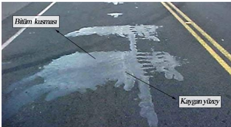
Resim 2.4. Asfalt kaplamada bitüm kusması [41]
