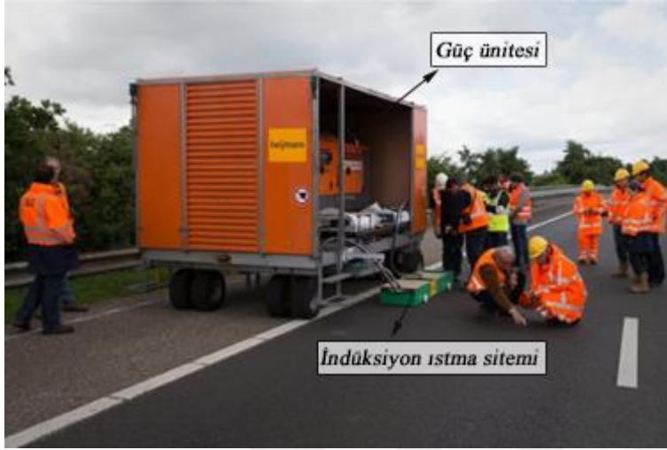
Resim 2.13. Hollanda’da bulunan A58 karayolunda araca monte edilmiş indüksiyon cihazı ile yapılan iyileştirme işlemi [95]
