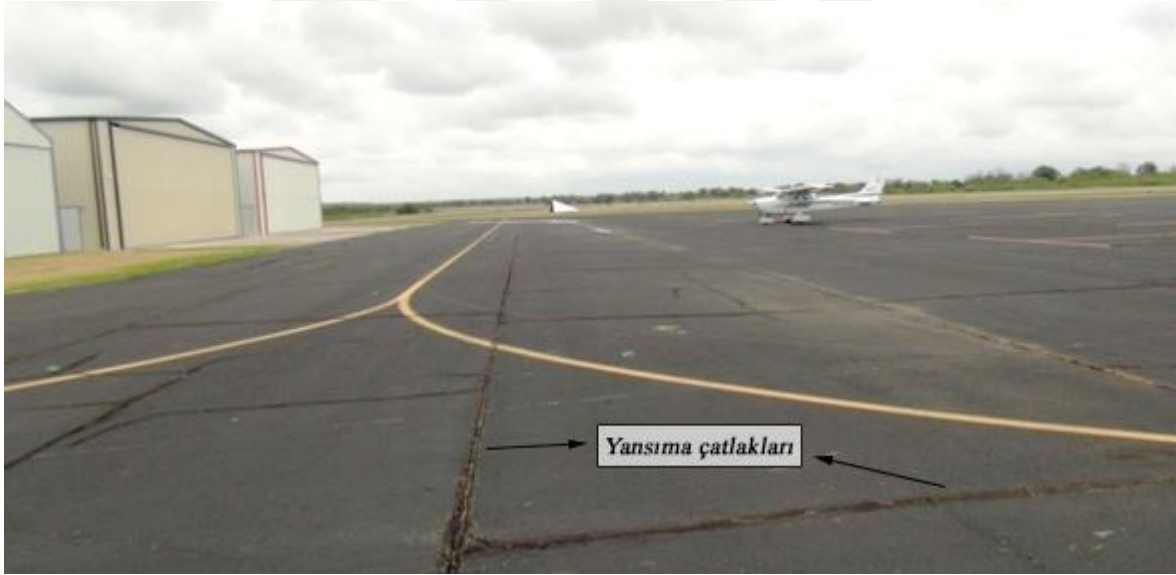
Resim 2.10. Esnek kaplama altında yer alan rijit kaplamanın yansıma çatlaklarına sebep olduğu görülmektedir [45]
