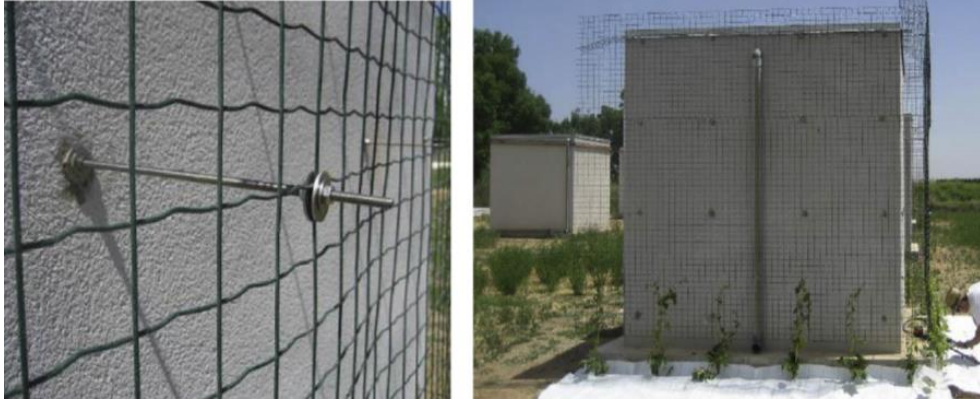
Resim 3.1. Deney ünitesine çift çeperli yeşil cephe kurulumu (Coma vd, 2017)
