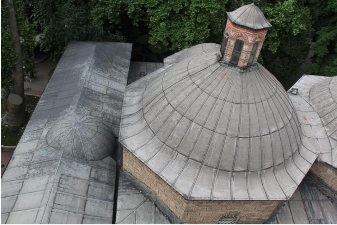
Resim 3. 8. İshak Paşa Camii harim mekanı aydınlatma feneri.
