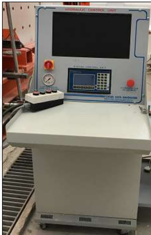
Şekil 7.2. Hidrolik kontrol ünitesi
