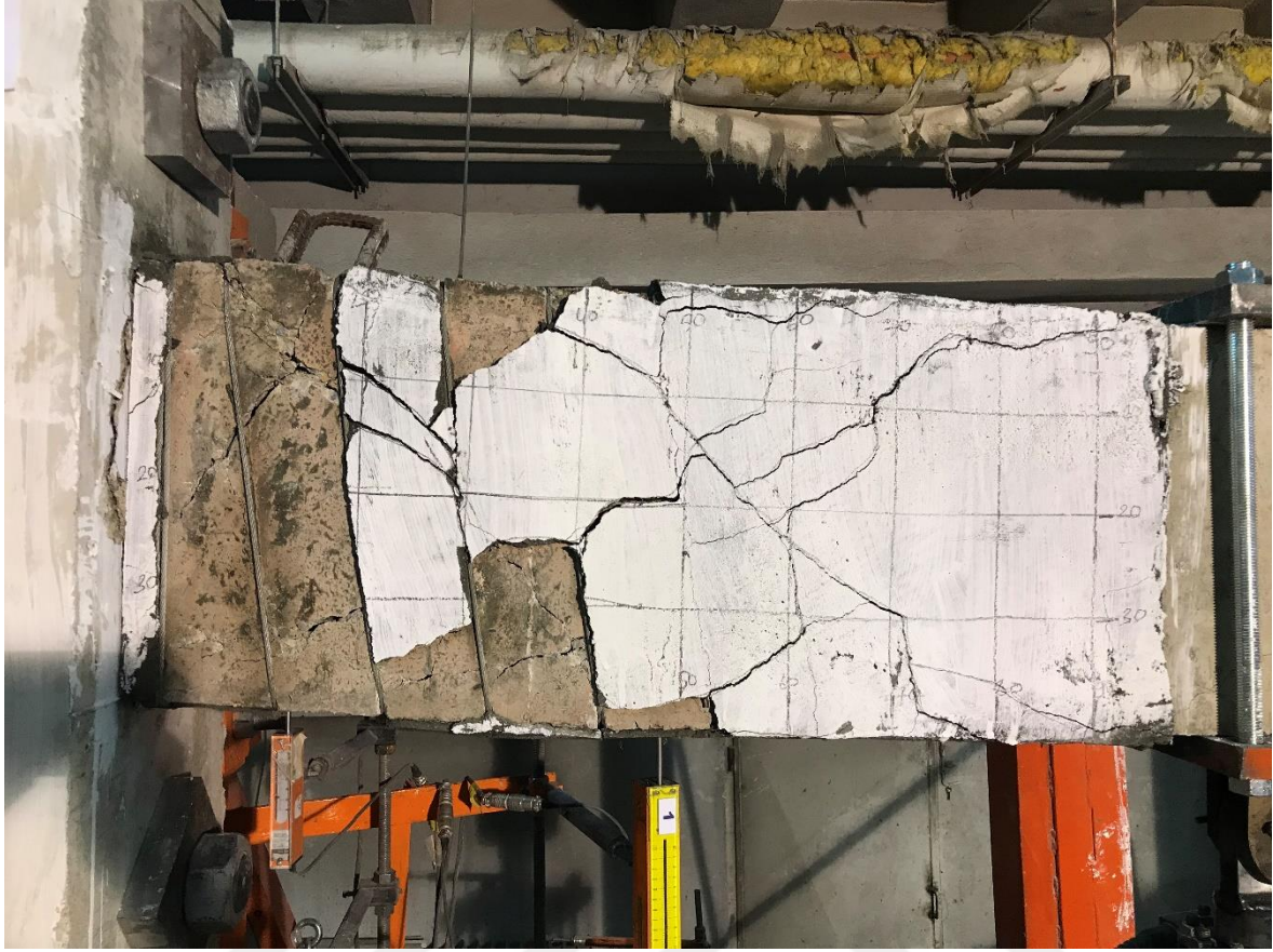
Resim 4.17. Sıva-beton kenetlenme probleminden ötürü dökülmeler
