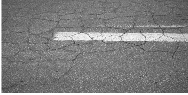
Şekil 2.23 Timsah sırtı çatlak (Bağdatlı, 2010).
