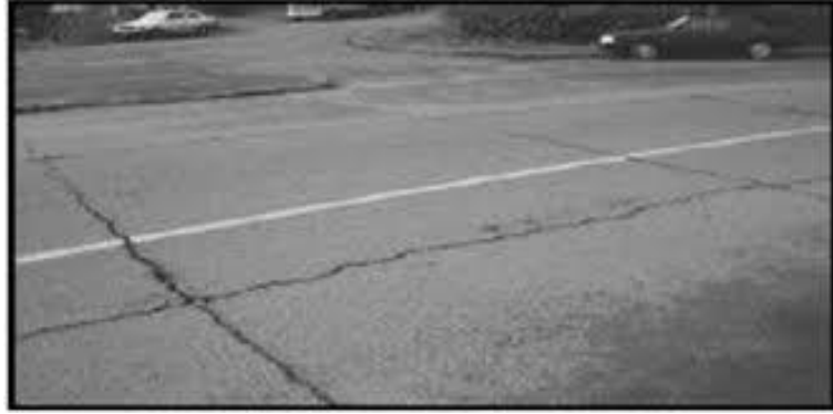
Şekil 2.24 Termal çatlak oluşumu.
