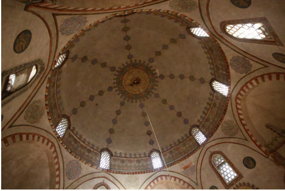
Resim 8. Hünkar Camii, Kubbe Detayı (22.09.2013)
