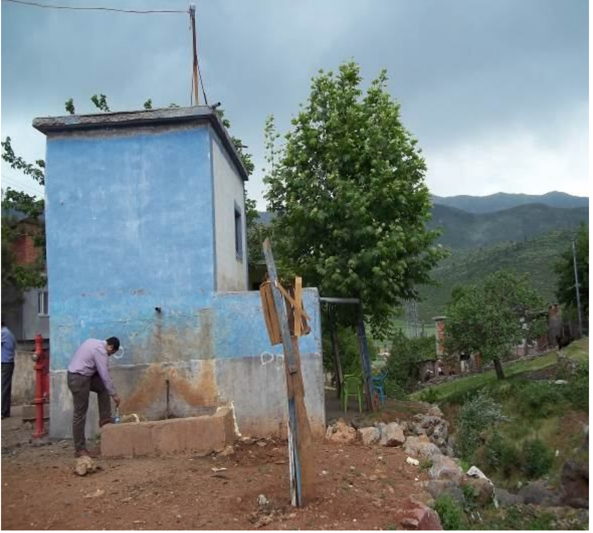
Şekil 2.7. Yolderesi köyü içme suyu deposu (kurt pınarı kaynağı)
