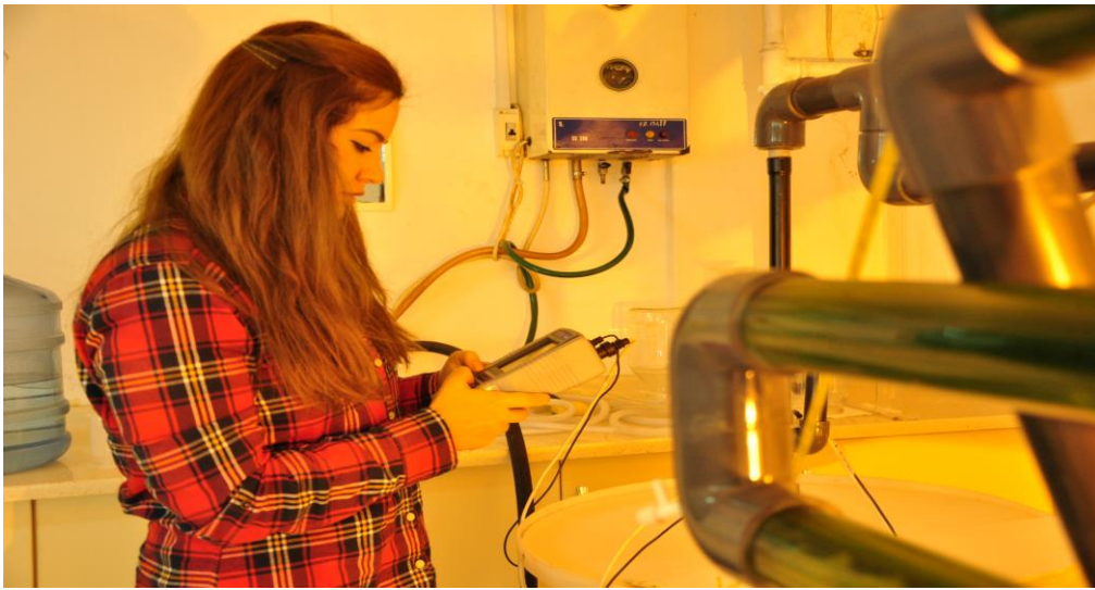
Şekil 3.14 Sistemde yapılan pH kontrolü.
