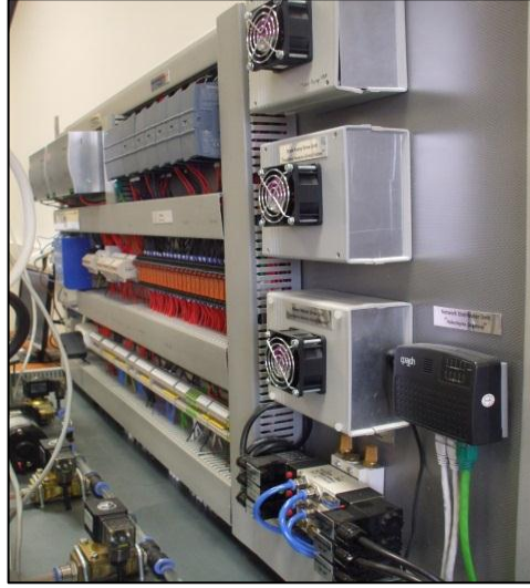
Şekil 3.21. Debi kontrolü uygulaması
