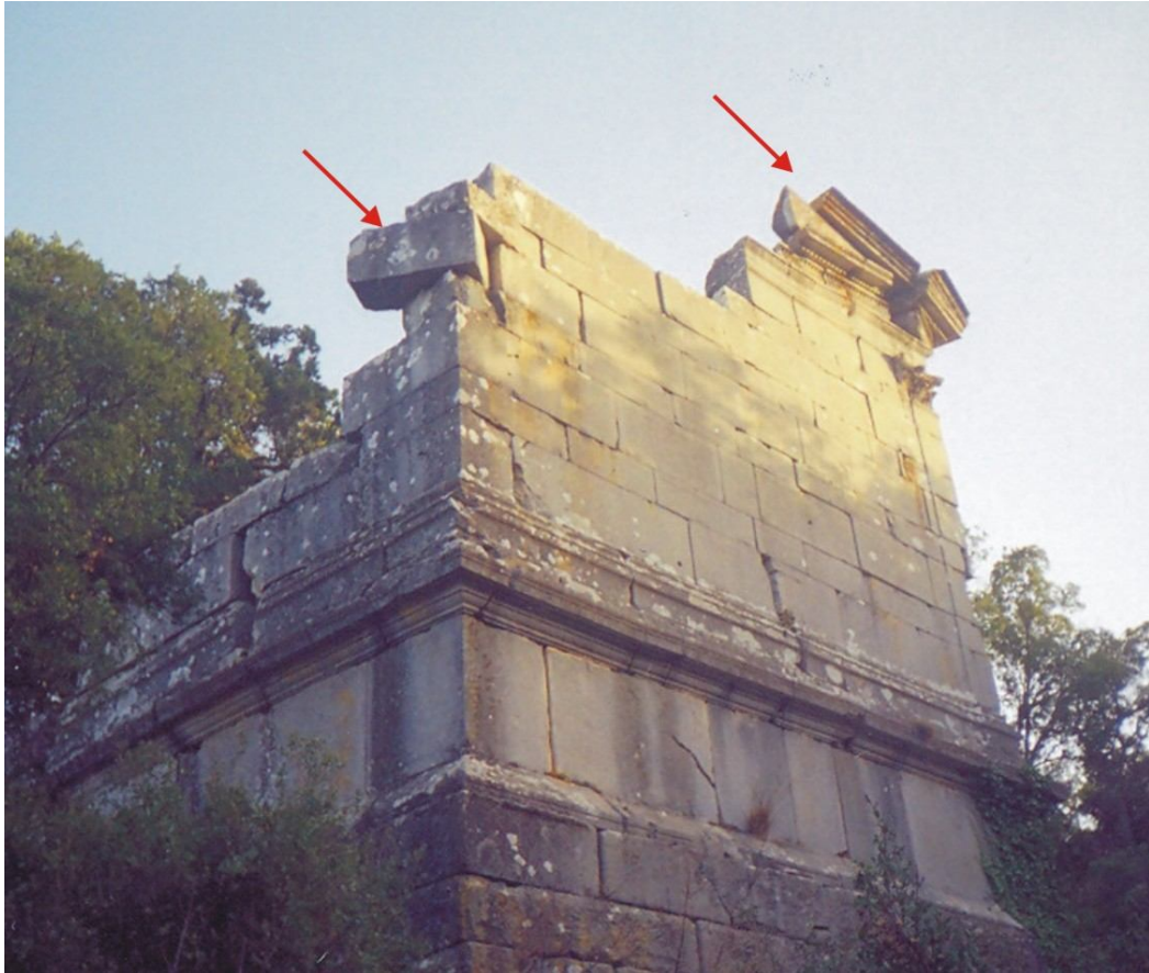
Şekil 4.55. Korint Tapınağı ve Attalos Stoa’ sında sismik etki ile oluşmuş duvar parçalarının dönüş hareketi
