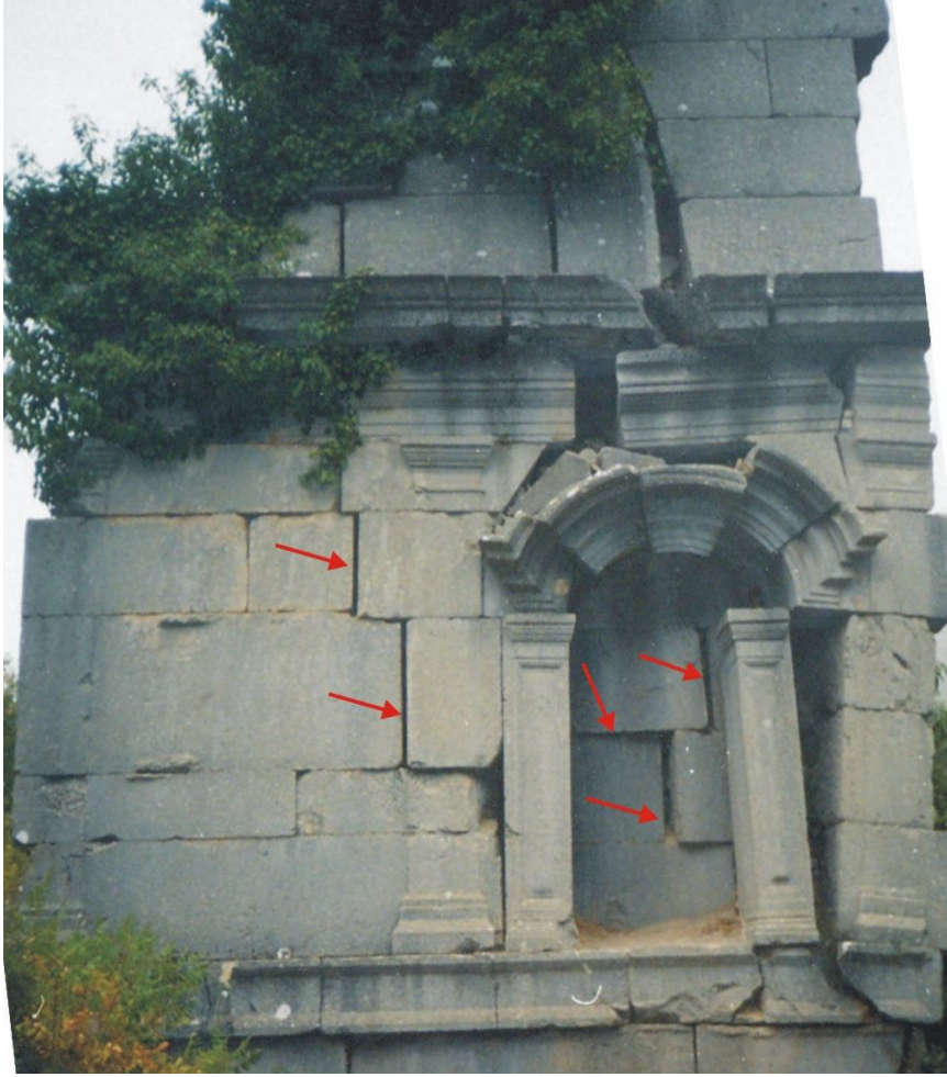
Şekil 4.60. Hamam duvarında sismik etki ile oluşmuş duvar tuğlalarının kısmen itilmesi
