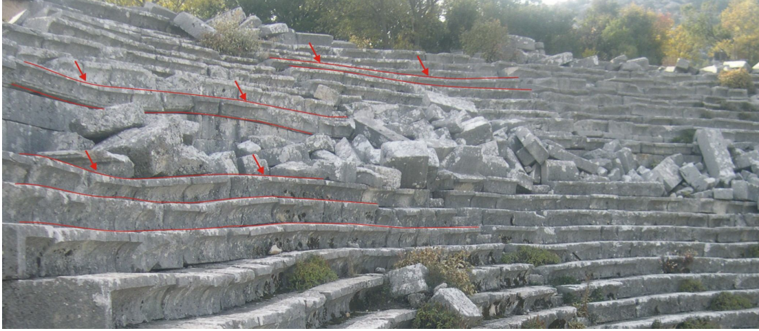
Şekil 4.58. Tiyatronun güney duvarında sismik etki ile oluşmuş duvar parçalarının dönüş hareketi
