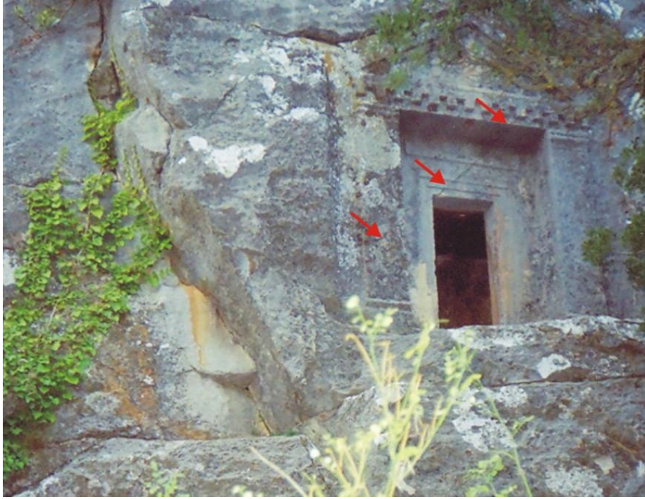
Şekil 4.54. Kaya mezarda sismik etki ile oluşmuş çatlaklar
