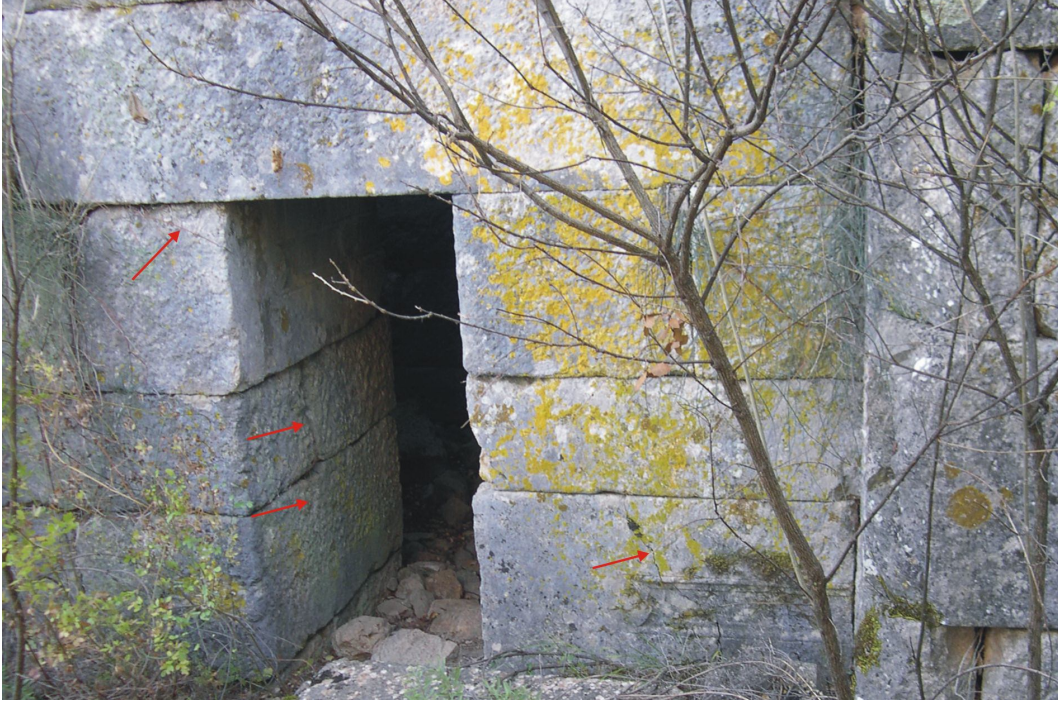
Şekil 4.51. Kent giriş kapısında sismik etki ile oluşmuş çatlaklar
