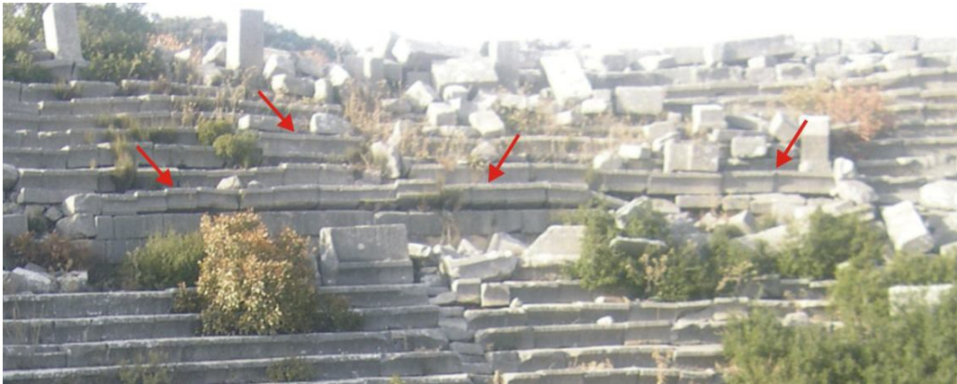
Şekil 4.59. Tiyatronun güneybatı duvarında sismik etki ile oluşmuş duvar tuğlalarının kısmen itilmesi
