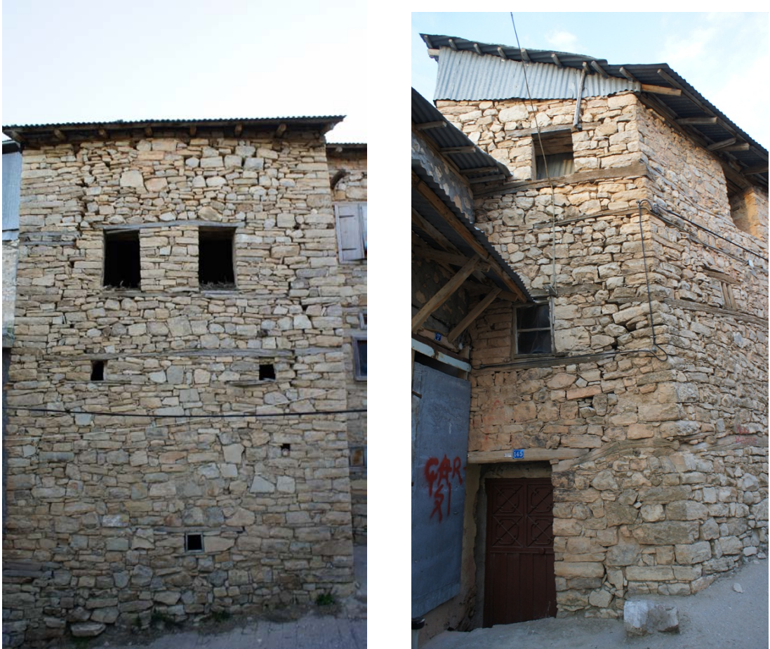
Şekil 6. 1 Strüktürel çatlakları olan ve özgün çamur derzleri boşalmış evler, 181-11 ve 252-4 yapıları
