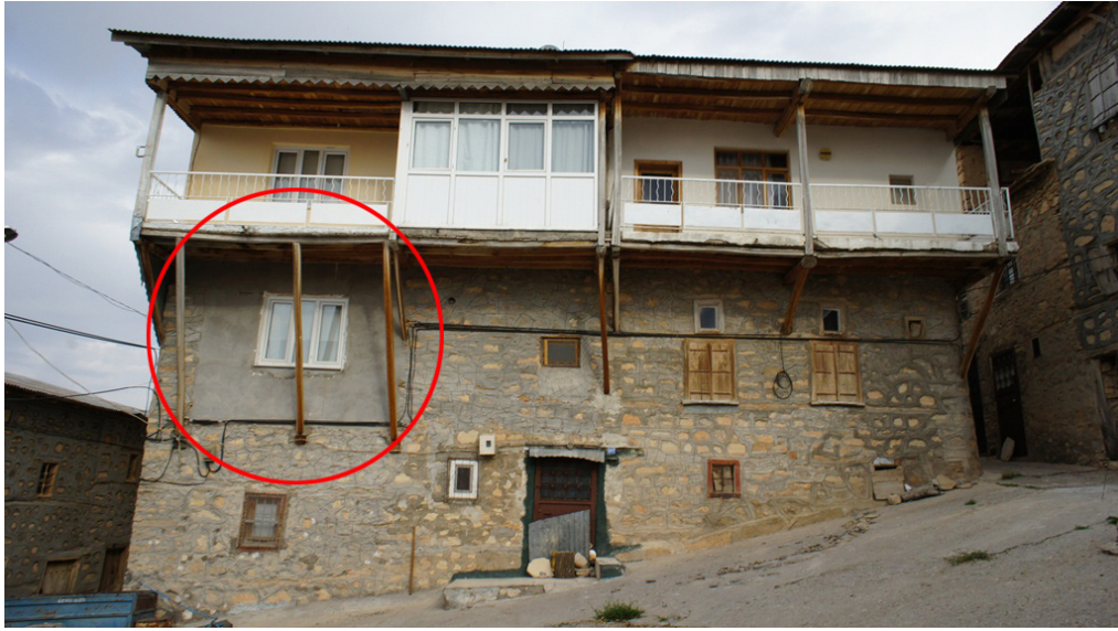
Şekil 6.8 Çardağın kapatılarak odaya dönüştürülmesi, 272-23 yapısı
