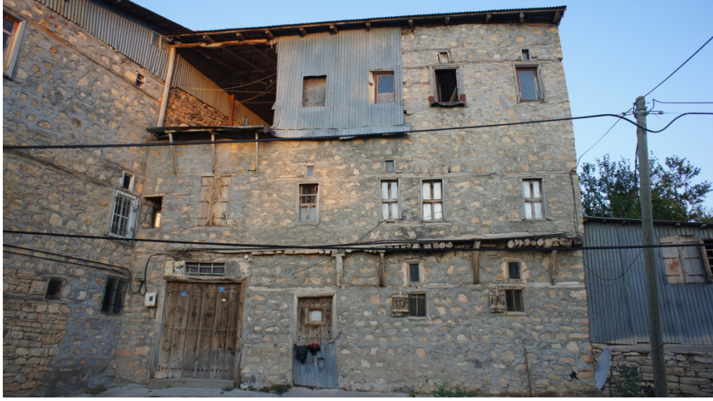
Şekil 6. 4 Cephe çimento malzeme ile yapılan derz dolguları, 270-91 yapısı
