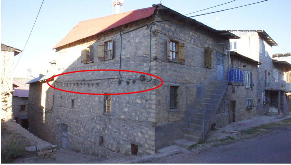
Şekil 6. 13 Yıkılmış örtmenin izini gösteren kirişler, 263-1 yapısı
