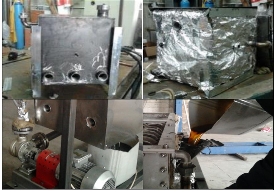
Şekil 3.27. Kızgın yağ tankı ve pompası
