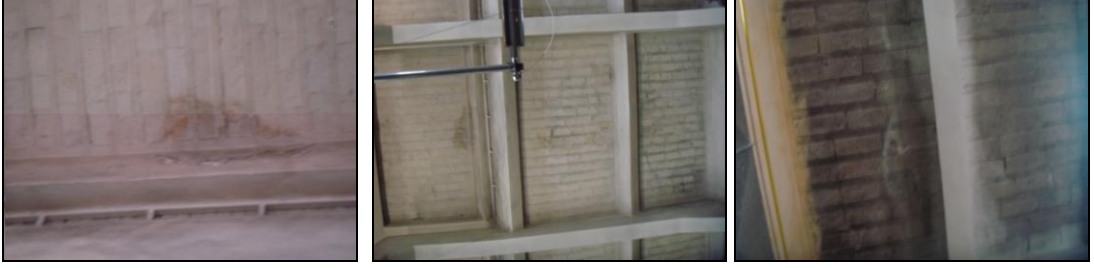
Şekil 5. 12961. Üst örtü kaynaklı nem problemleri
