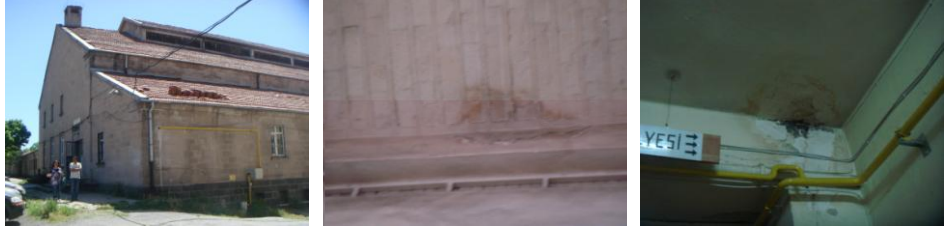
Şekil 5. 12255. Günümüzde gözlemlenen duvar bozulmaları
