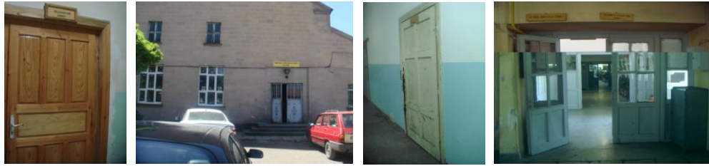
Şekil 5. 12356. Günümüzde gözlemlenen duvar bozulmaları
