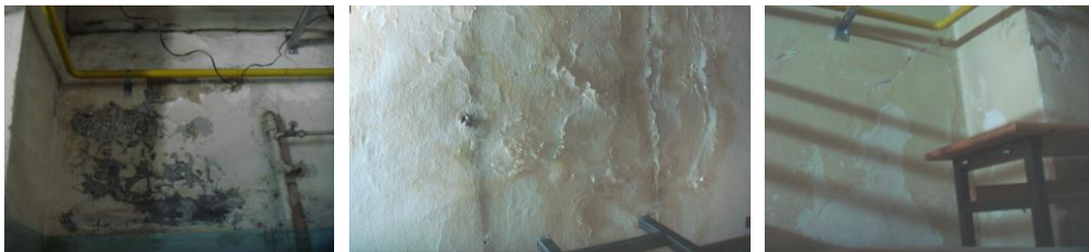
Şekil 5. 12154. Günümüzde gözlemlenen duvar bozulmaları
