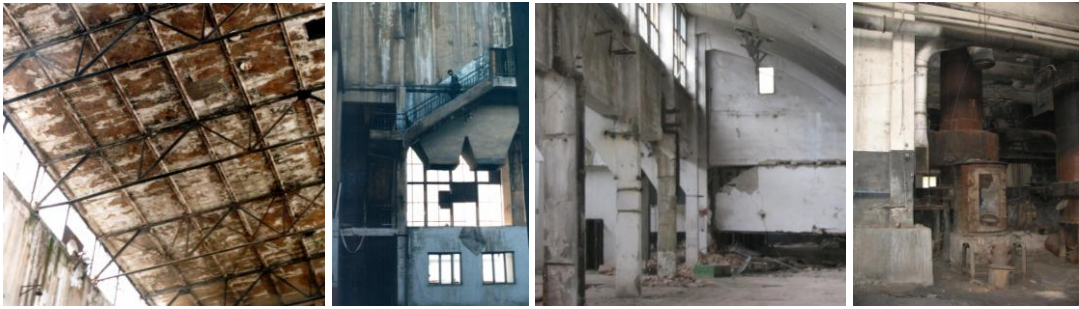
Şekil 5. 102. Elektrik santrali, üretim yapısı ve dökümhaneden kimyasalla maruz kalmış detayların görselleri
