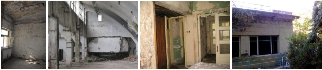
řekil 5. 101. Bitiř elemanlarında g zlemlenen bozulması  rnekleri
