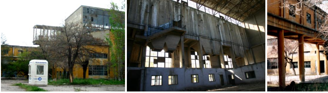
Şekil 5. 90. Elektrik Santrali Görünüşleri
