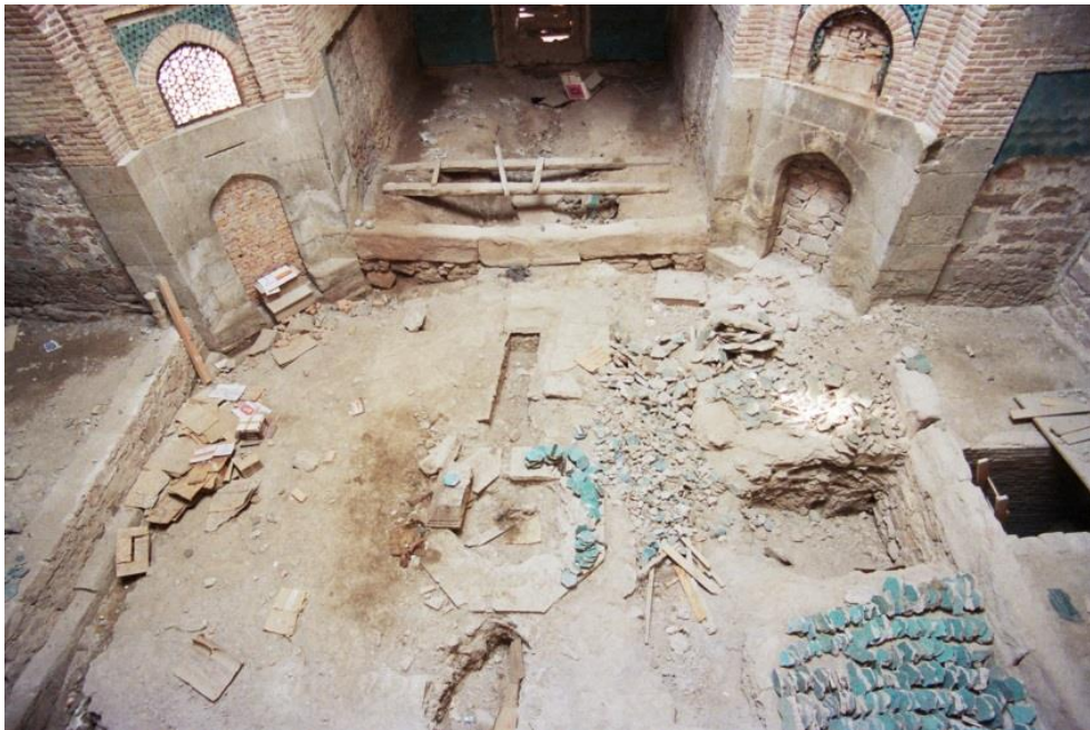
Fotoğraf 101: Hanikah ve batı eyvanı onarım öncesi.
