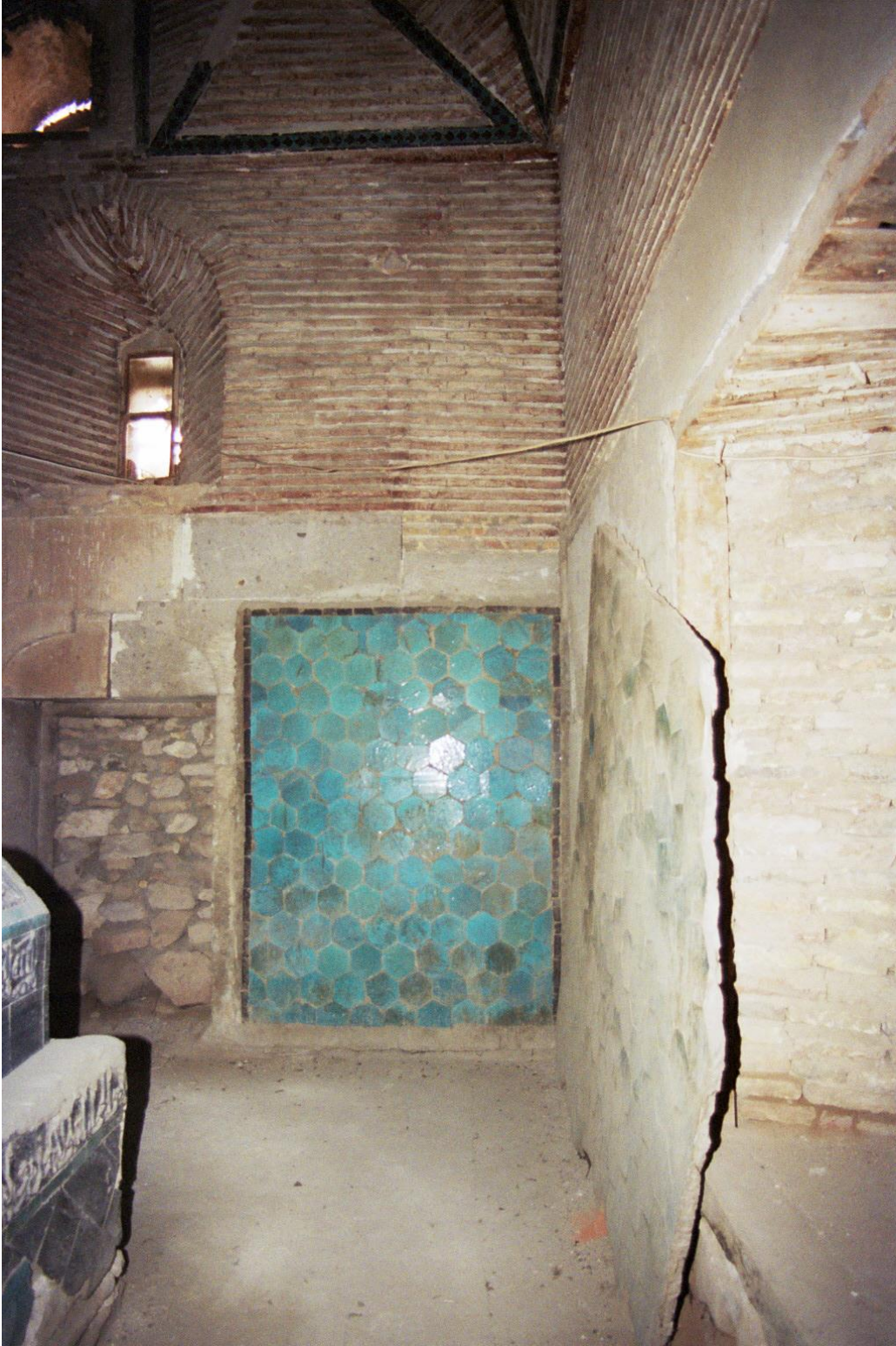
Fotoğraf 106: Türbe duvarı onarım öncesi. (Konya Vakıflar Bölge Müdürlüğü'nden alınmıştır)
