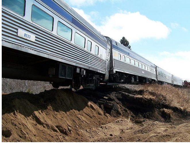
Şekil 3.10: Demiryolu hattı arazi platformunun çökmesi- Kanada, 2013.
