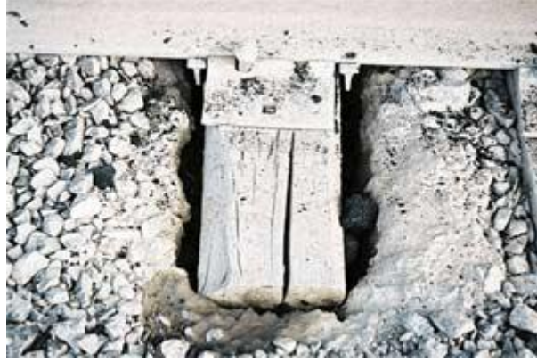
Şekil 3.12: Travers hareketinden oluşan pompalama etkisiyle travers etrafında boşluk oluşması.
