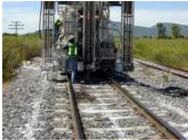
Şekil 3.11: Demiryollarında arazi platformu hasarları ve düzeltme çalışmaları.
