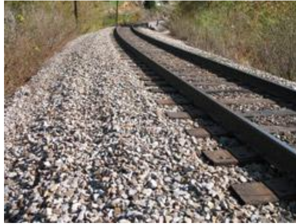
Şekil 3.20: Balastlı demiryolu hattı.
