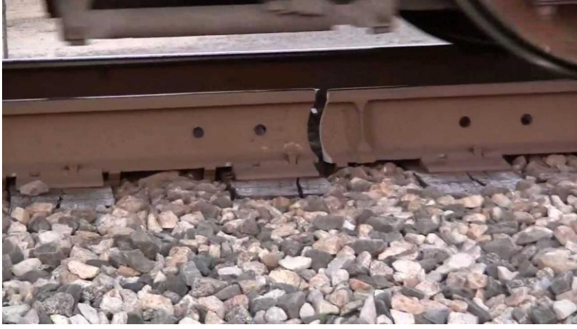
Şekil 3.15: Demiryollarında ray kırılması.
