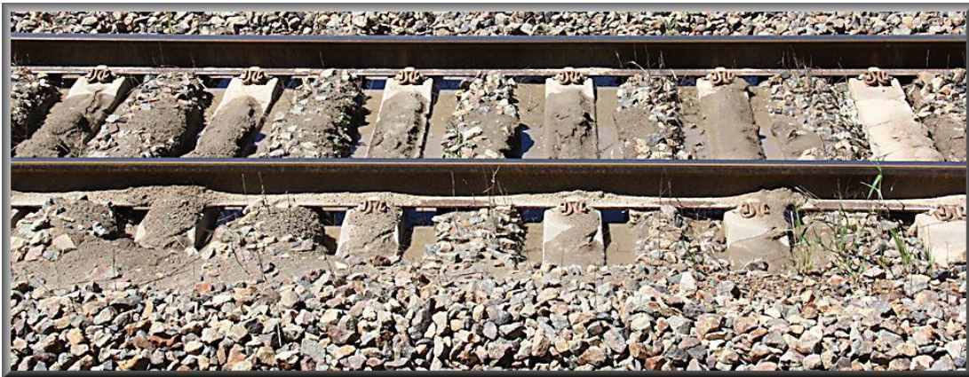
Şekil 3.13: Demiryolu arazi platform hasarları.
