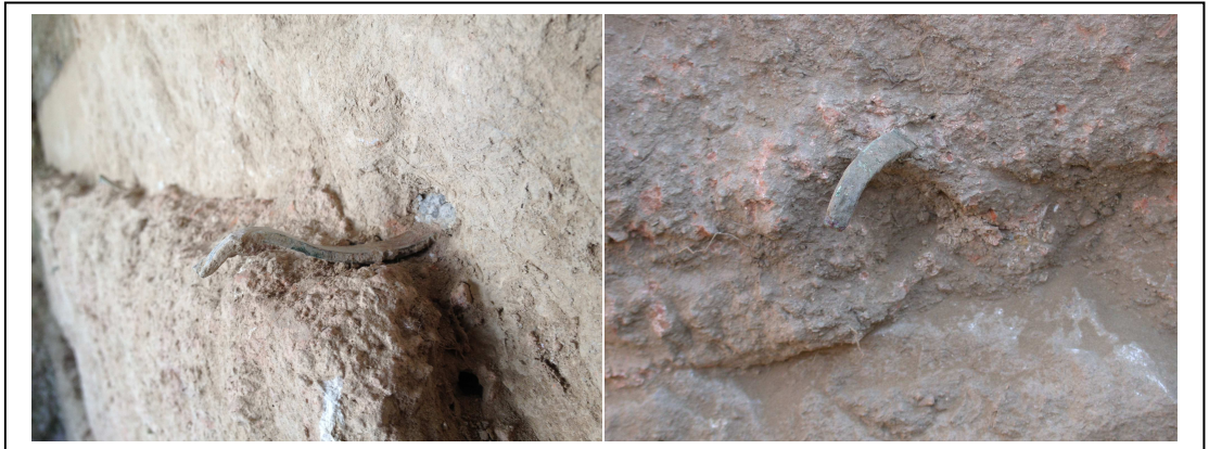
Res. 3. Aşağı Hamam (Büyük Hamam) duvarındaki kaplama pimi.
