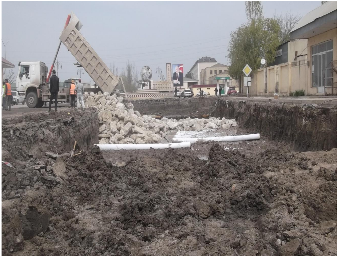
Şekil 3.20. Güzergahın km: 47+100-sol tarafından 1.5 metrelik kazının ardından çıkan zayıf zemin (CH- Organik kil)
